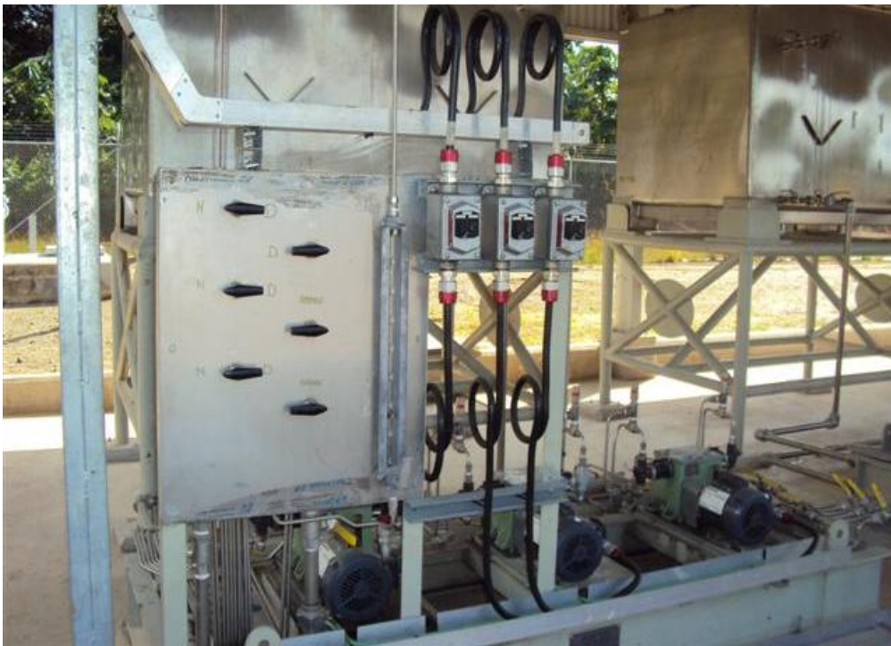
Figura 2.10 Paquete de Químicos (Tanques).
