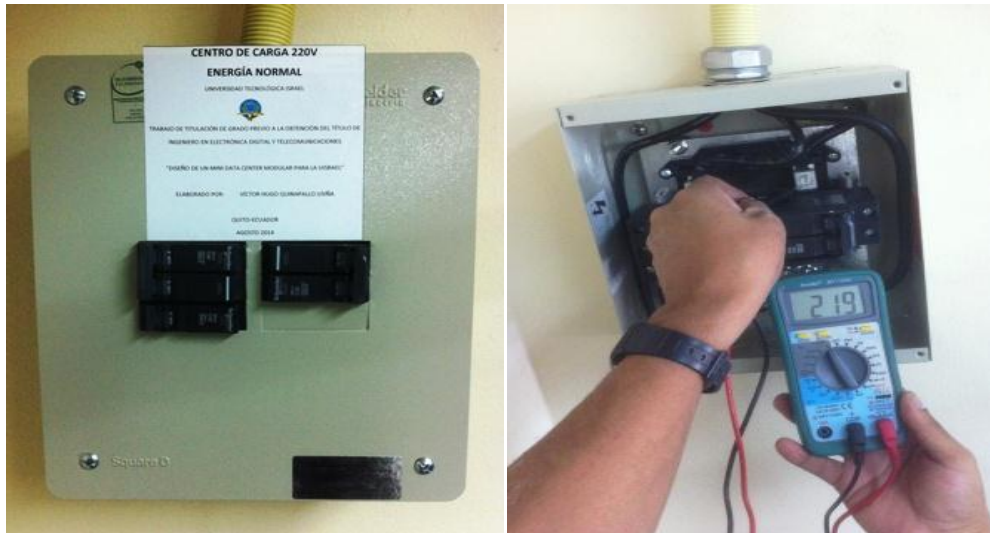
Figura 3.7 Instalación y medición del voltaje, del Centro de Carga ubicado en la Sala de Unidad de Apoyo, Espacios y Tecnología, Piso 3; requerido para alimentar el Mini Data Center Modular IDS2000-S.
