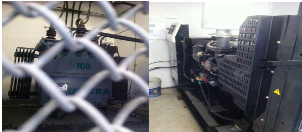
Figura 3.3 Generador ó Planta Eléctrica y Cámara de Transformación 100 KVA existentes, Subsuelo 1 UISRAEL.
