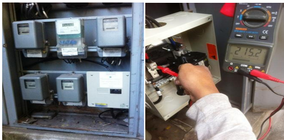
Figura 3.6 Instalación y medición del voltaje, de la Caja de Paso SQD ubicada en el Tablero de Distribución General (TDG), Subsuelo 1; dedicado para alimentar el Mini Data Center Modular IDS2000-S.
