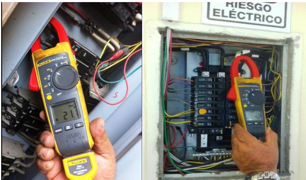
Figura 3.8 Medición de corriente en Tablero de Distribución Principal (TDP), Tablero de Distribución Secundario (TDS), acometida eléctrica existente de la UISRAEL.
