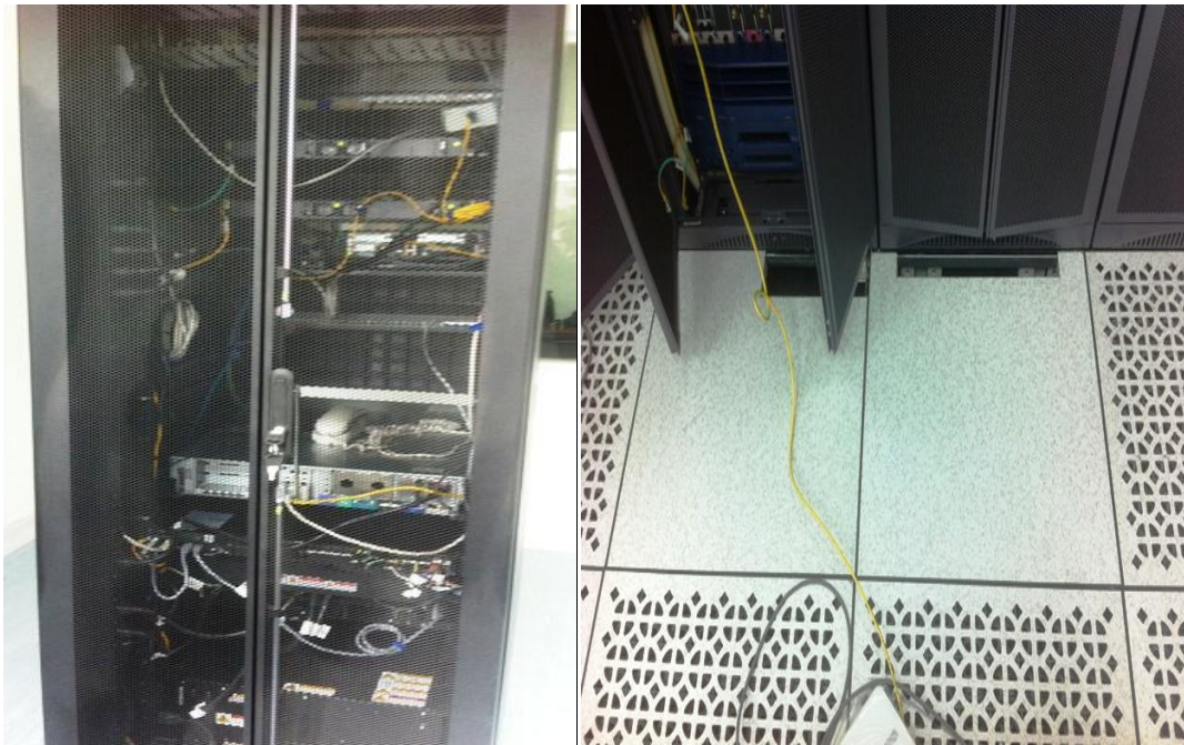
Figura 1.6 Racks con malla en la parte trasera y baldosas perforadas que ayudan a mantener frío el ambiente del Data Center.
