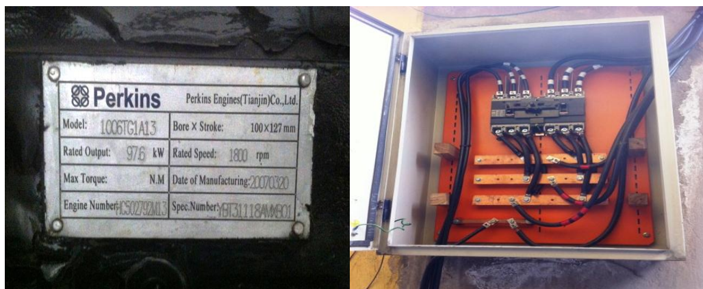
Figura 3.4 Características del Generador 97,6 kW y Tablero de Transferencia Manual (TTM) de la acometida eléctrica existente de la UISRAEL.
