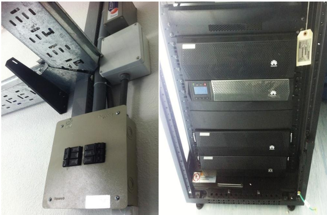
Figura 1.4 Suministro de energía eléctrica 220 VAC, PDU, UPS y baterías de respaldo dentro del rack Mini Data Center Modular.
