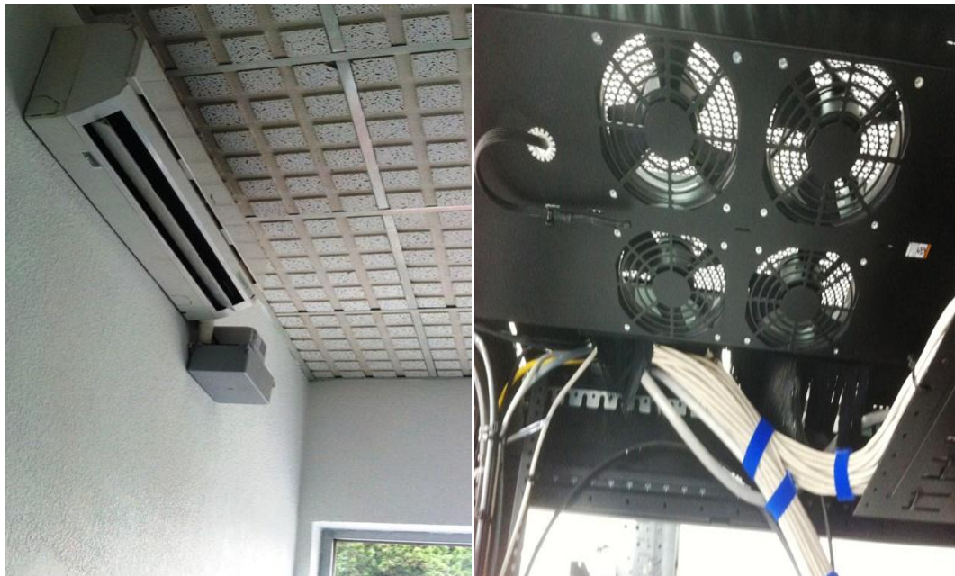
Figura 1.5 Refrigeración y ventiladores que ayudan a bajar el calor de los equipos dentro del rack del Mini Data Center.
