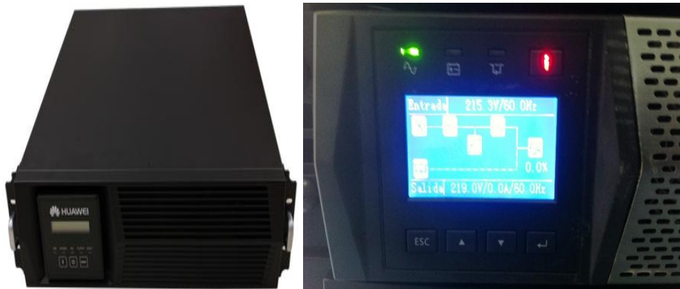
Figura 2.4 UPS 6 KVA, en Modo Principal.
