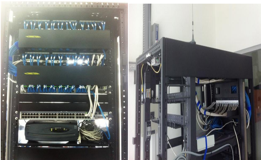
Figura 1.3 Administración de cableado estructurado y parcheo de patch-cords.
