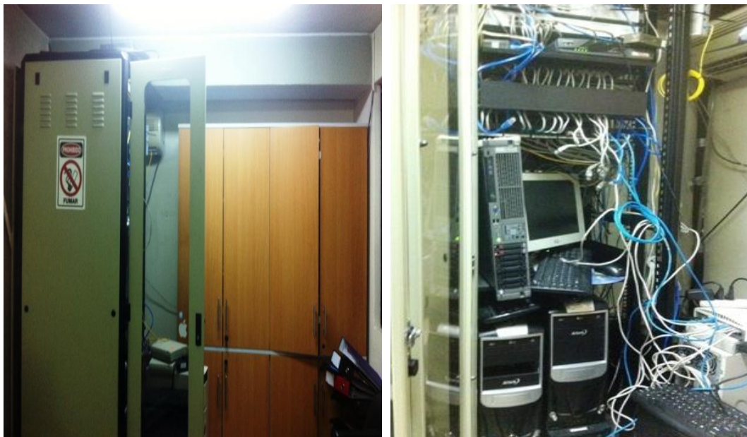
Figura 3.1 Rack de Datos actual, ubicado en el 3er. Piso Sistemas UISRAEL.
