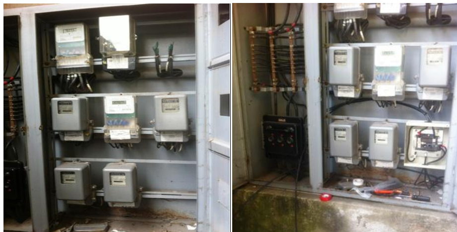
Figura 3.5 Antes y después de la instalación de la nueva acometida eléctrica AC, circuito dedicado para la implementación del Data Center Modular IDS2000-S, 3er. Piso UISRAEL.
