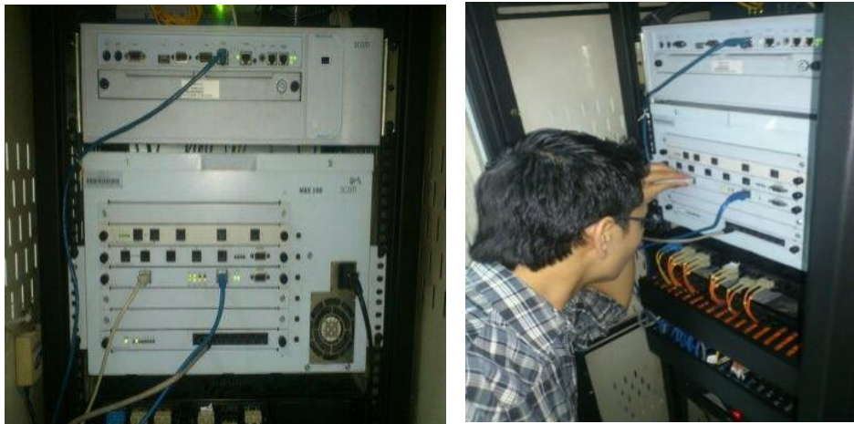
FIGURA 3.45 Central telefónica IP antigua del Hospital Axxis.
