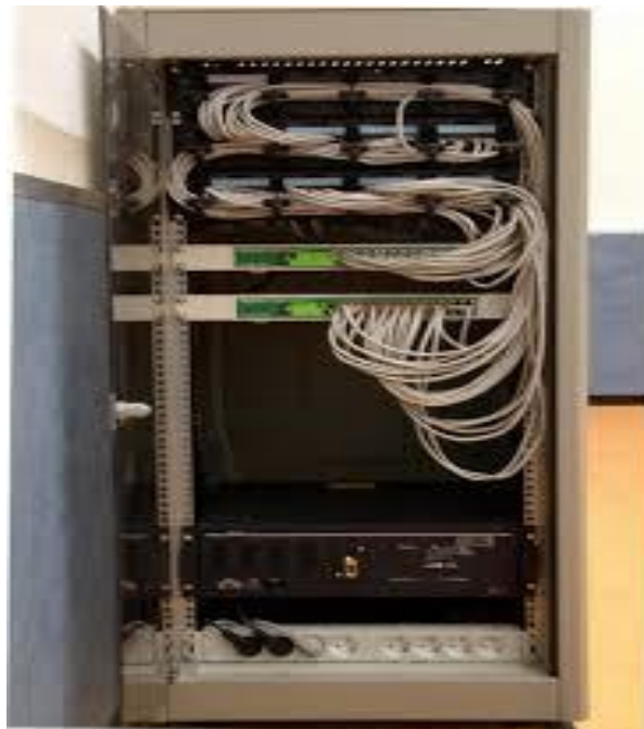
Figura 2.15 Cuarto de Equipos Fuente: (Sistema de Cableado Estructurado, 2014)
