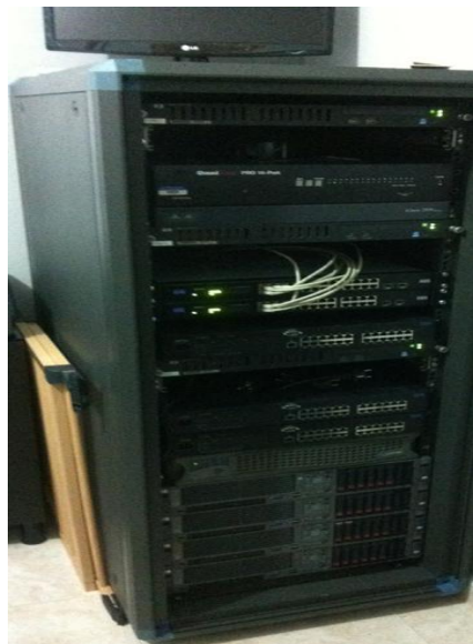
Figura 38 Data Center Grya Fuente: (Grya, 2014)
