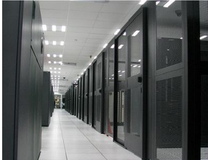
Figura 26 Data Center Telconet Fuente: (Grupo Telconet, 2012)
