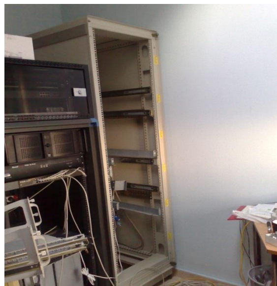
Figura 24 Rack de Equipos Fuente: (Grya, 2014)
