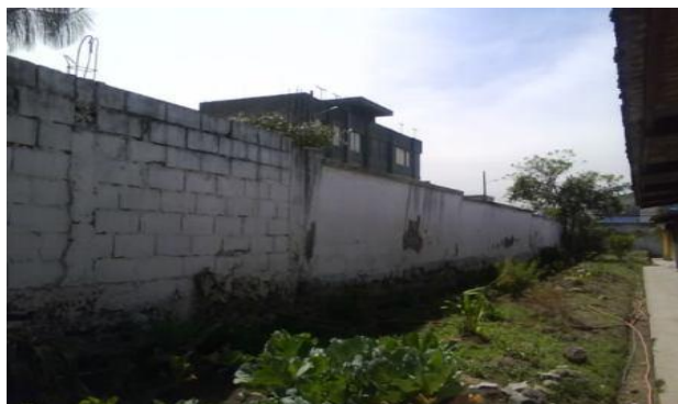
Anexo 10: Escuela República de Italia, el muro está inclinado.
