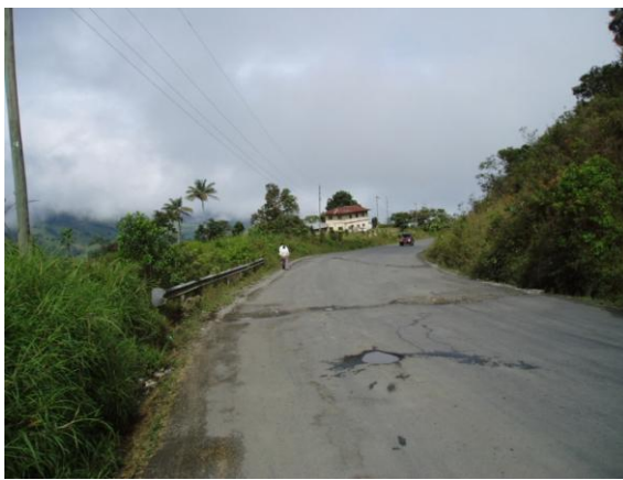
FOTO 1.- La calzada presenta dos fracturas indicando que hay una falla de la estructura del pavimento.
