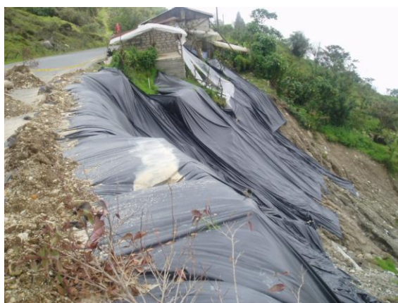
FOTO 10.- Punto Crítico PR 3 (km 45+850) en el sitio Virgen de la Consolación.
