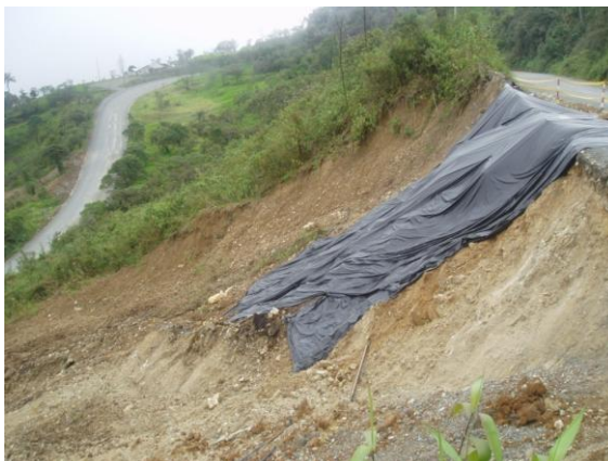
FOTO 14.- Este deslizamiento afecta la parte alta por el daño de la vía y afecta la parte de abajo por exceso de material que inunda la vía.
