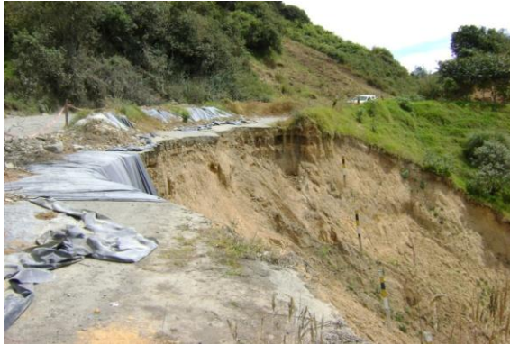
FOTO 2.- Afectación de un carril de la vía y destrucción total de las cunetas.
