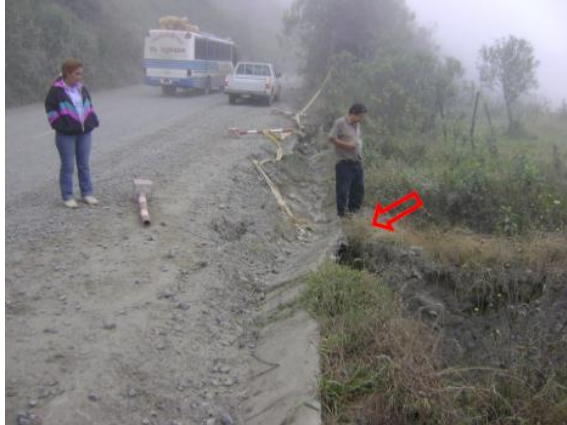
FOTO 13.- La vía se encuentra en servicio, el problema encontrado es local
