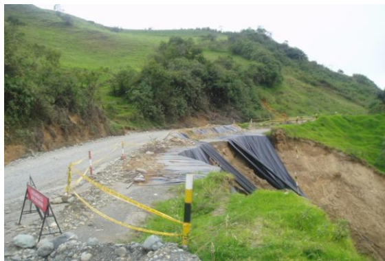
FOTO 3.- El deslizamiento corta medio carril de la vía, la solución inmediata fue mover el eje hacia el talud interno.
