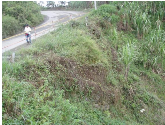
FOTO 16.- Falla del gavión, barandas y cunetas por erosión descontrolada.
