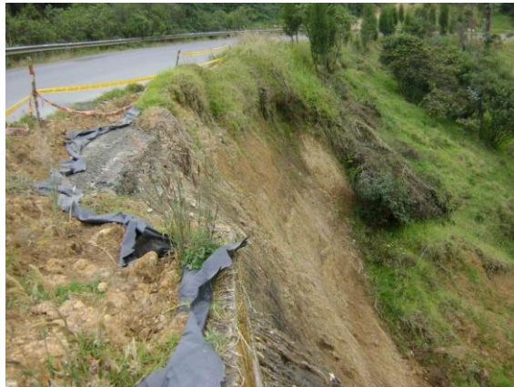
FOTO 1.- Abscisa 28+160. La vía es construida sobre un dique que cierra una quebrada. Vista hacia el sur del sector deslizado del dique de la vía.
