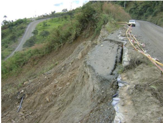
FOTO 12.- Se observa el talud inferior de la vía, erosionado por las fuerzas de filtración, en materiales arenosos y limosos de origen residual.
