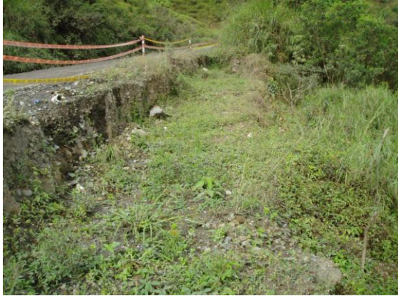
FOTO 2.- Abscisa 63+360. El muro de gaviones se ha desprendido completamente de su posición donde fue construido y se ha volteado hacia abajo en un giro de 90°.
