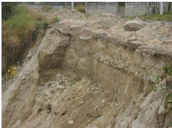
FOTO 8.- Taludes inferiores de la mesa de la vía en el sitio PR 45+850, afectados por procesos erosivos.
