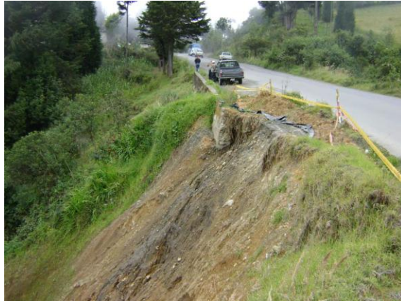
FOTO 2.- Abscisa 28+160. Vista hacia el Norte del sector deslizado del dique de la vía.
