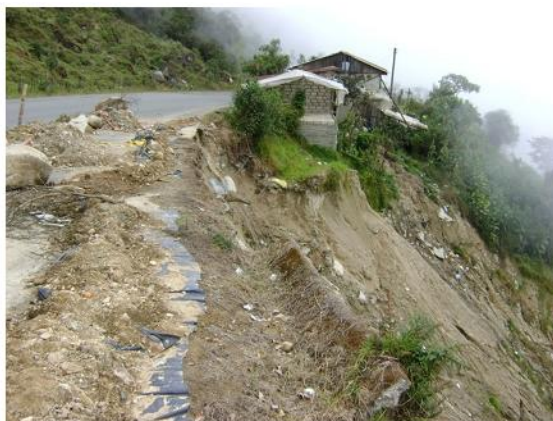
FOTO 9.- Tramo de vía afectado por la erosión de los taludes inferiores, se observa destrucción parcial de las cunetas.
