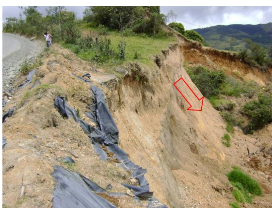
FOTO 7.- Superficie de falla y corona del deslizamiento tipo rotacional.
