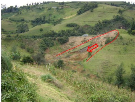
FOTO 5.- Taludes inferiores de la mesa de la vía en el sitio PR 41+000, afectados por un deslizamiento de tipo rotacional, se observa la antigua alcantarilla destruida.
