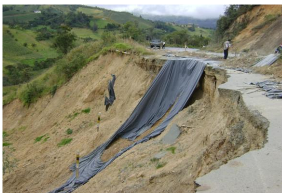
FOTO 1.- Taludes inferiores de la mesa de la vía en el sitio PR 40+000, afectados por un deslizamiento de tipo rotacional.
