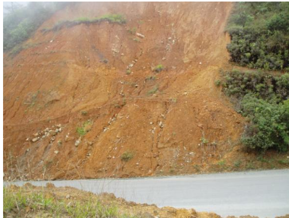
FOTO 1.- Abscisa 55+500. Deslizamiento circular en suelos rojizos profundos, en corte de la vía.
