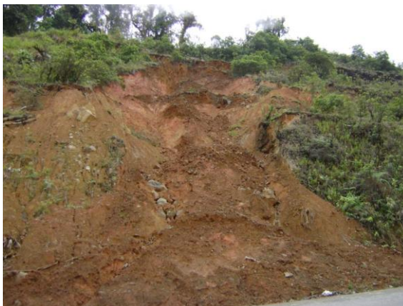
FOTO 1.- Talud previamente estabilizado con bermas (a la derecha) que han fallado por mal drenaje y exceso de agua en los colectores.
