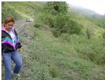
FOTO 1.- Abscisa 63+360. El problema se limita al muro de gaviones. La calzada no presenta fallas.
