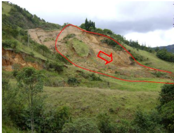
FOTO 4.- Talud inferior de la mesa de la vía en el sitio PR 41+000, afectados por un deslizamiento de tipo rotacional.
