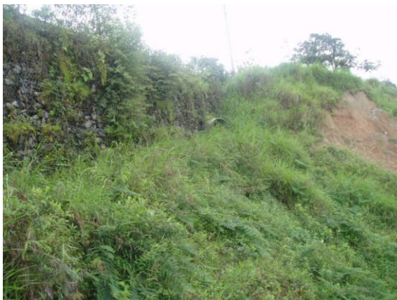
FOTO 2.- El muro de gaviones aunque no ha fallado, presenta pequeños hundimientos que denotan su inestabilidad similar a la estructura de la calzada.
