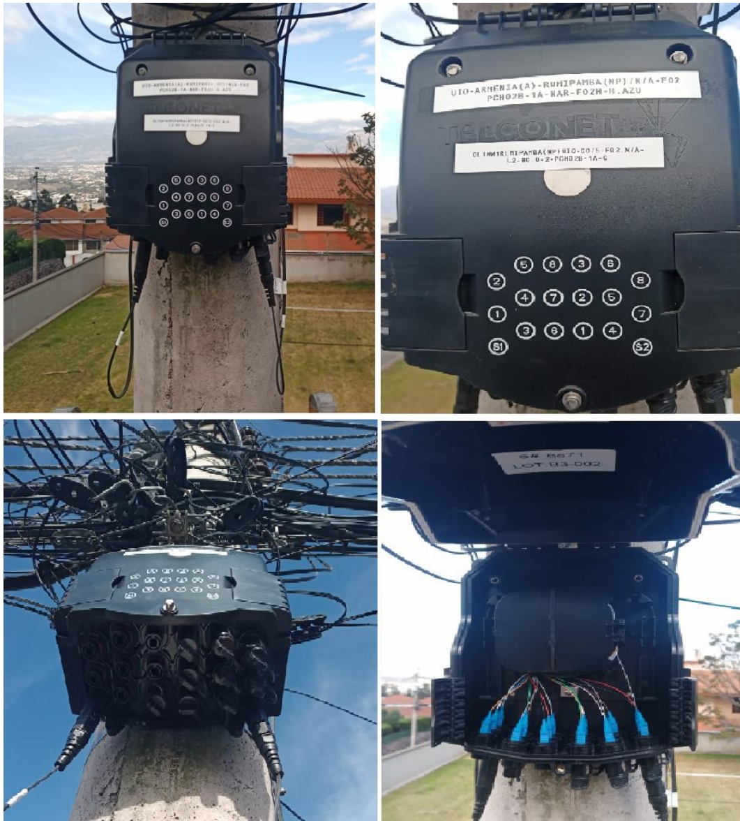
Figura 36.- Caja instalada Fuente: Autor
