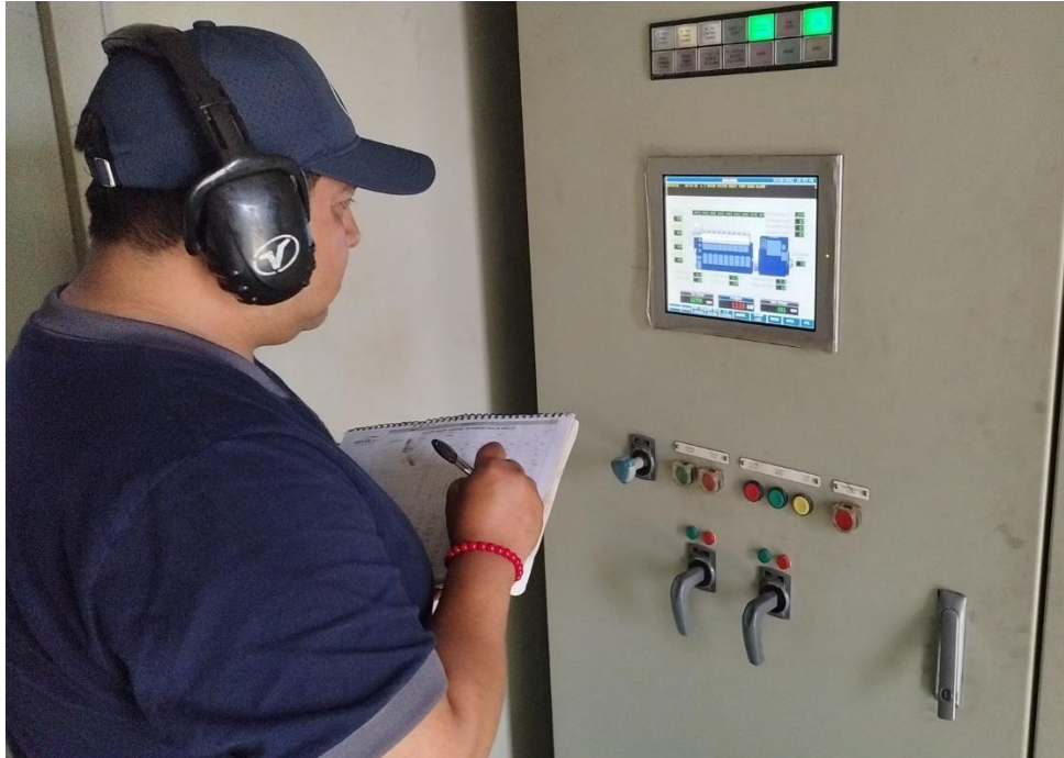
Figura 37: Nueva forma de monitoreo de temperaturas de combustión del motor
