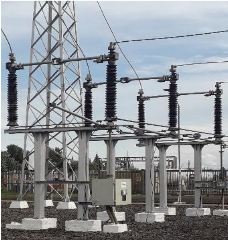
Seccionadores de línea
