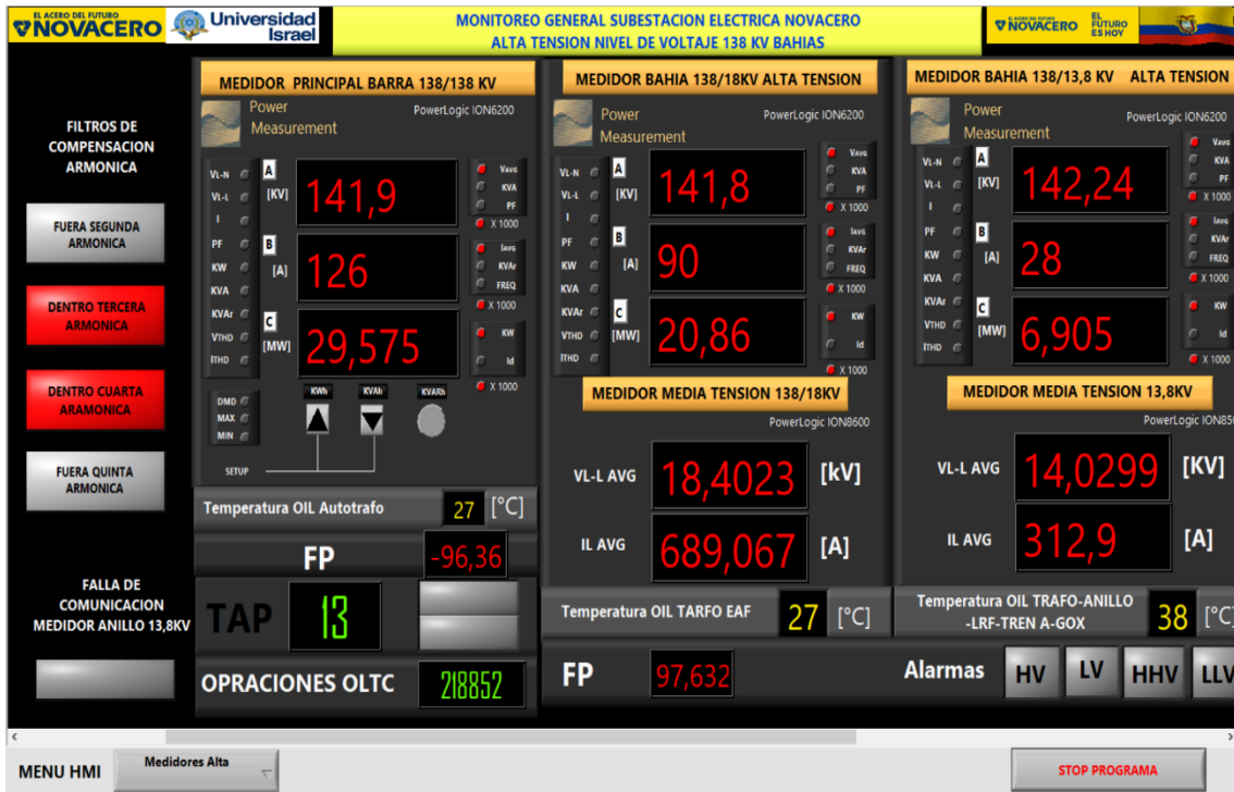
Pantalla medidores alta tensión
