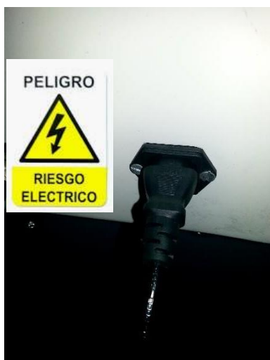
Figura 9. Cable trifásico enchufado. Fuente: Chalá 2020
