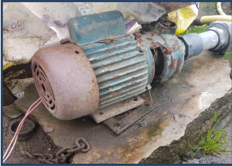
Figura 4.6 Estado inicial de la bomba de agua.
