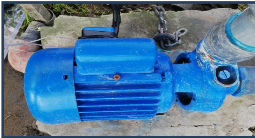
Figura 4.8 Bomba de agua después del mantenimiento.
