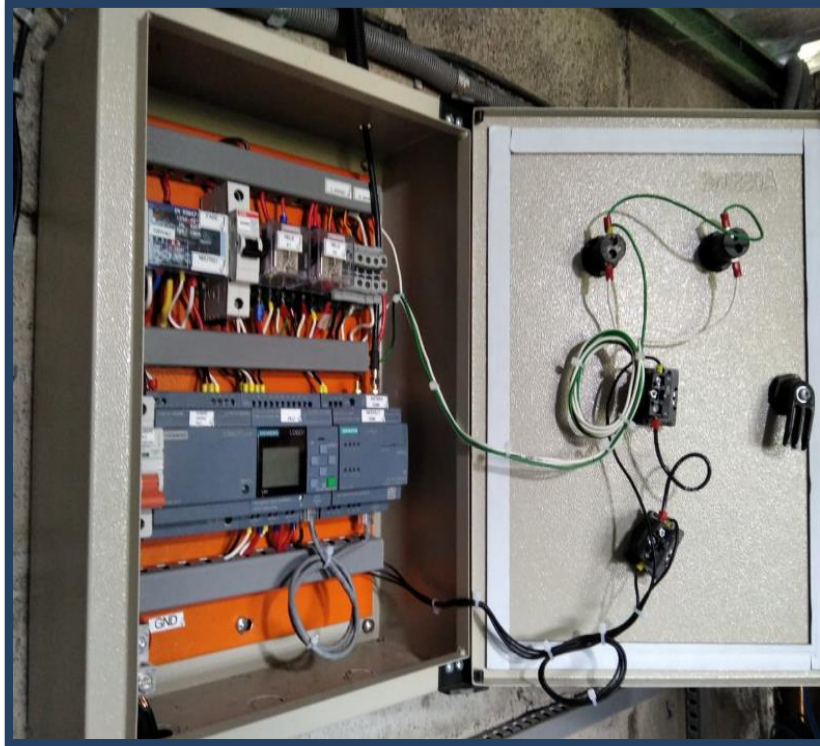
Figura 4.18 Tablero de control parte interna.
