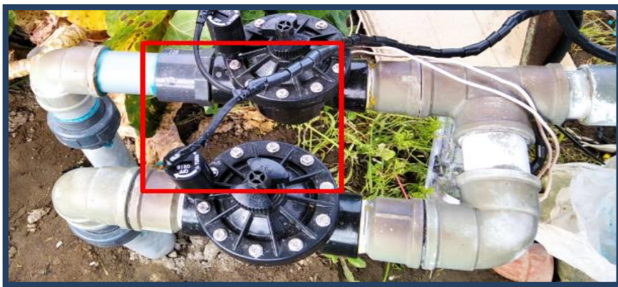
Figura 4.16 Protección de los cables de alimentación. Fuente: Autor.
