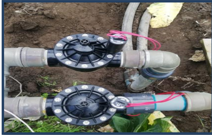
Figura 4.11 Electroválvulas con el respectivo control. Fuente: Autor
