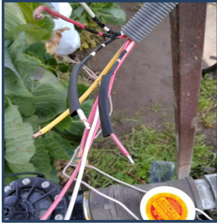
Figura 4.15 Cables de alimentación. Fuente: Autor.
