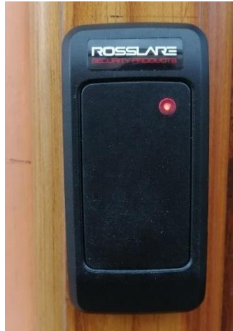
Figura 27: Lectora de proximidad instalada. Fuente: (Rosslare, 2019)
