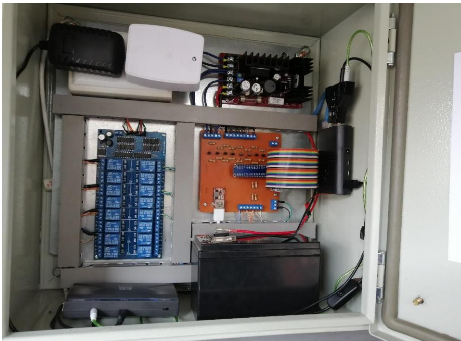
Figura 22: Tablero de control. Fuente: Elaborado por el autor
