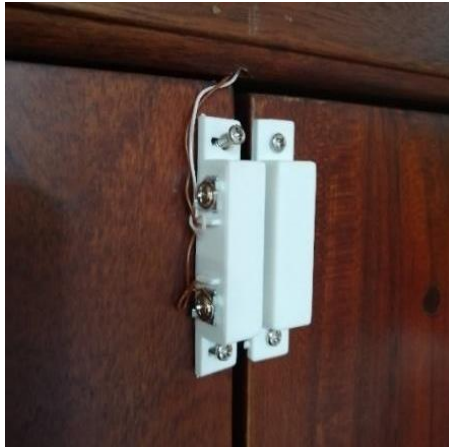
Figura 23: Instalación contactos magnéticos. Fuente: (Amazon, 2020)
