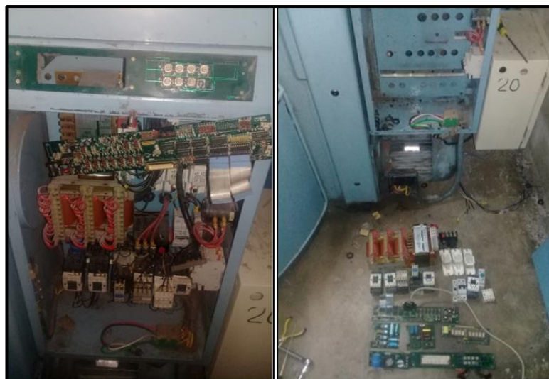
Figura. 4. 11. Armario de distribución
