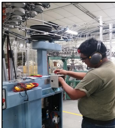
Figura. 4. 16. Fijación de la HMI
