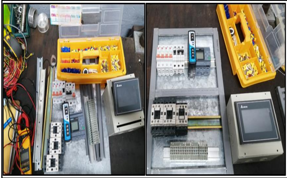
Figura. 4. 12. Componentes del tablero
