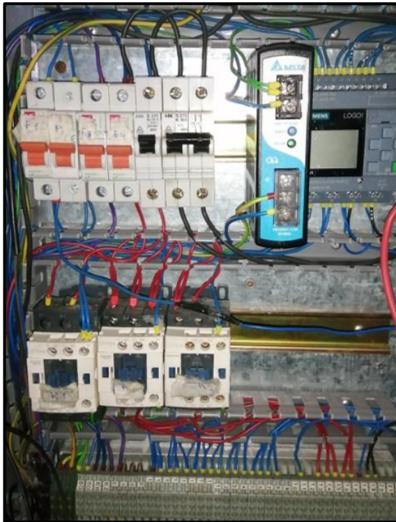
Figura. 4. 13. Cableado de tablero de control
