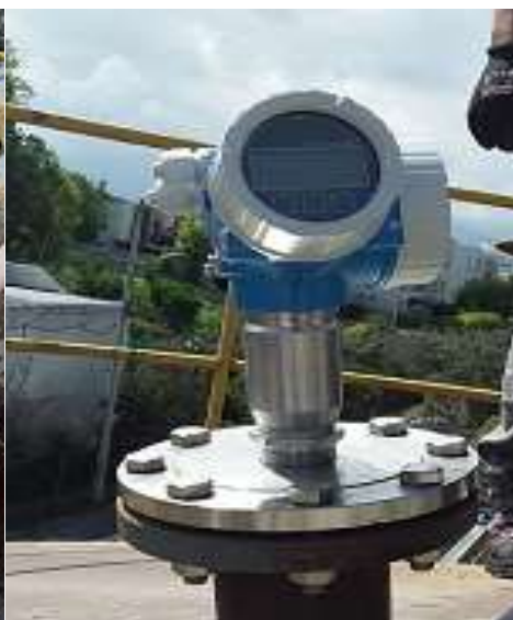
instalación del sensor
