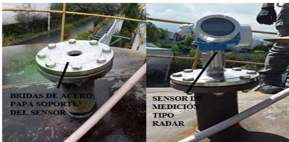
Figura 4. 1. Instalación del sensor de medición tipo radar
