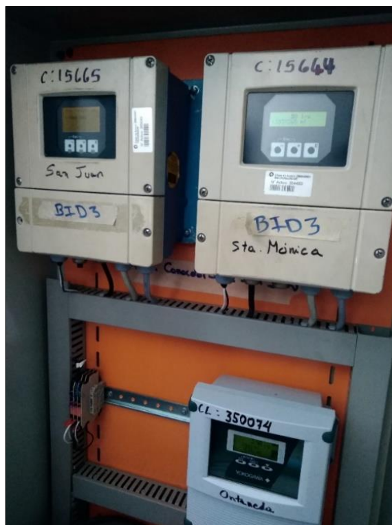
Figura. 3.8. Transmisores de las líneas de envío de agua potable Fuente: Elaborado por el autor
