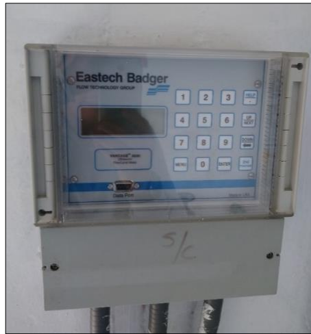
Figura. 3.5. Transmisor Vantage 2200 dañado en tanque de retrolavado Fuente: Elaborado por el autor
