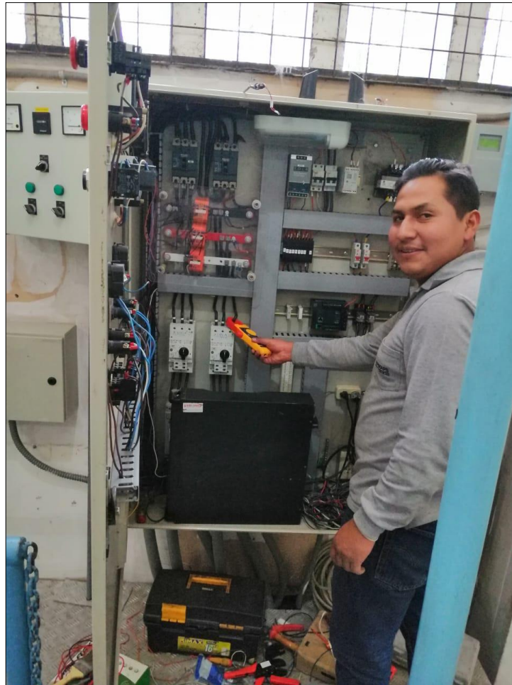
Figura. 4.31. Pruebas en tablero principal Fuente: Elaborado por el autor
