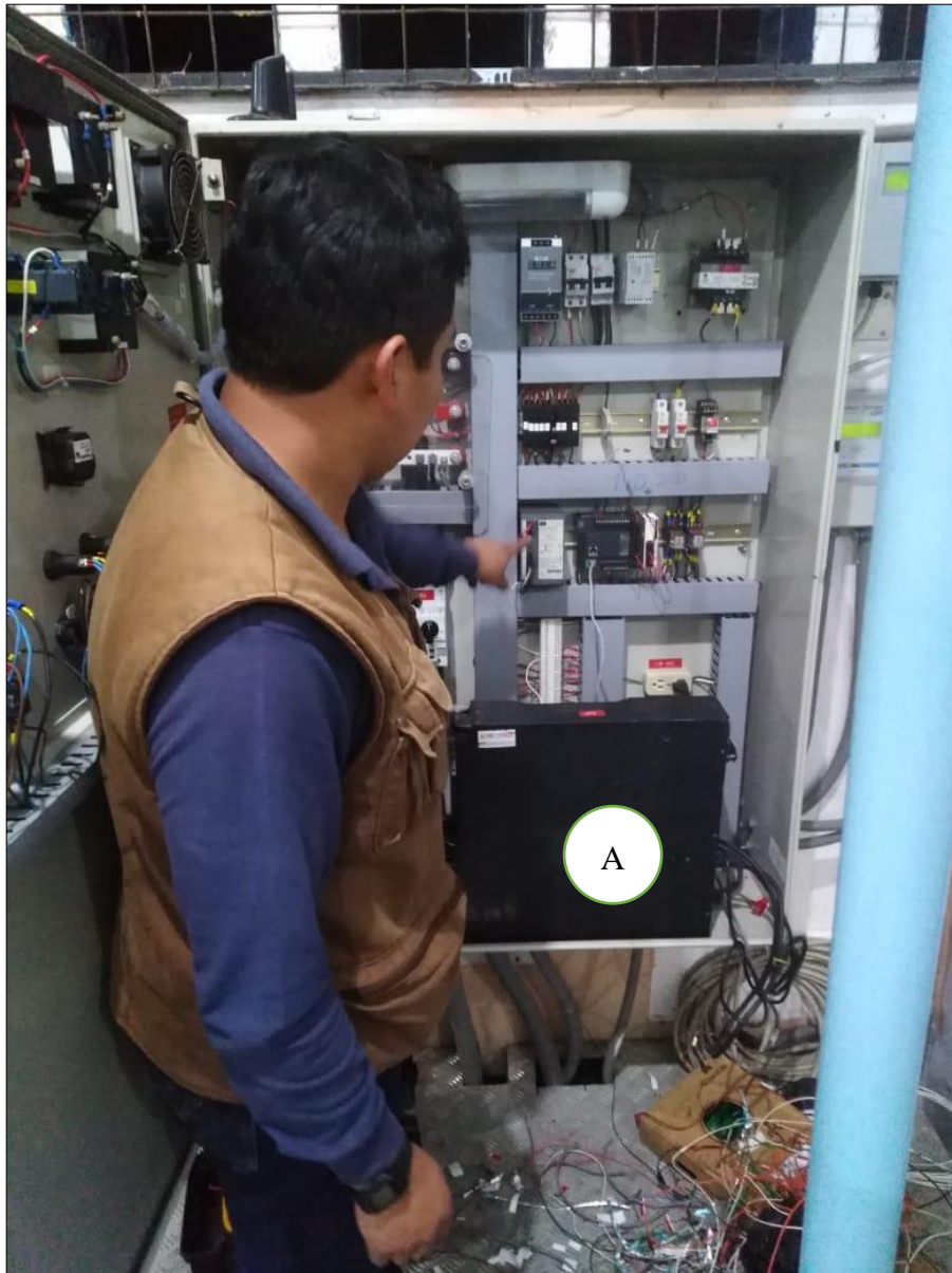
Figura. 4.32. Vista final del tablero de control Fuente: Elaborado por el autor
