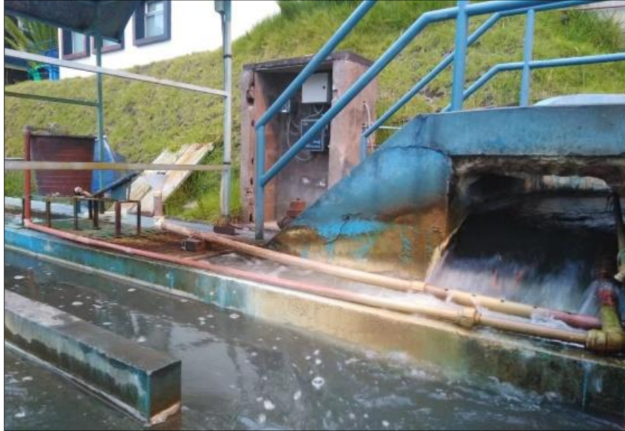
Figura. 1.1. Ingreso de agua cruda y mezcla rápida Fuente: Elaborado por el autor
