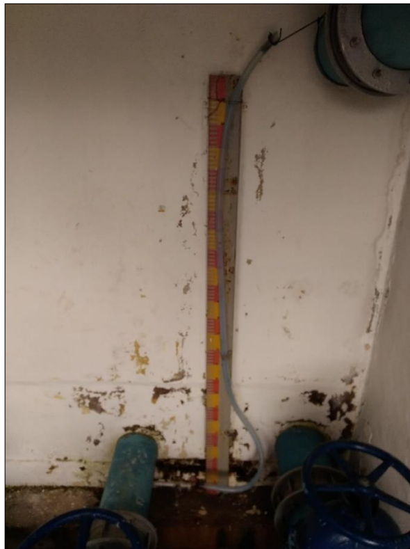
Figura. 3.6. Medidor de nivel mediante manguera Fuente: Elaborado por el autor
