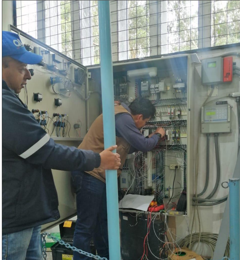
Figura. 4.21. Instalación de PLC y sus módulos Fuente: Elaborado por el autor
