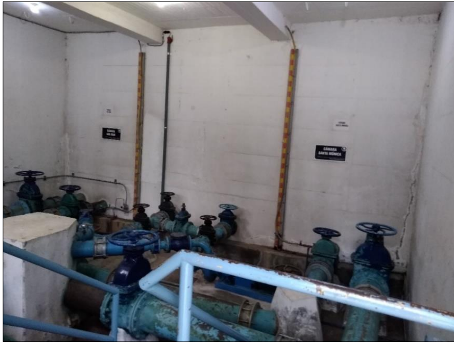
Figura. 1.6. Tanque de almacenamiento y líneas de distribución Fuente: Elaborado por el autor
