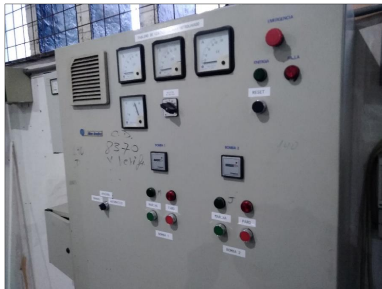
Figura. 3.33. Tablero principal Fuente: Elaborado por el autor
