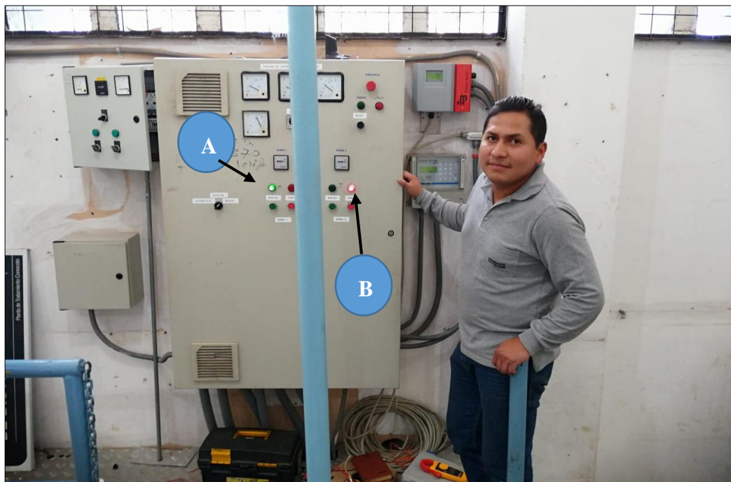
Figura. 4.30. Encendido de bomba desde el tablero principal
