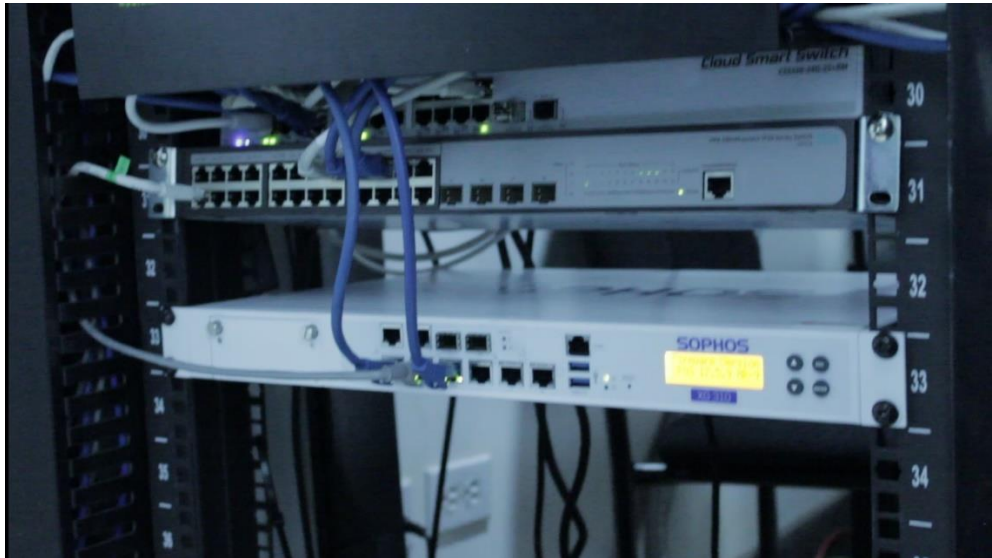
Figura. 4.17. Patch panel, switch de core y Sophos XG
