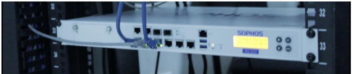
Figura. 4.35. Implementación de Sophos XG en el rack del centro de datos
