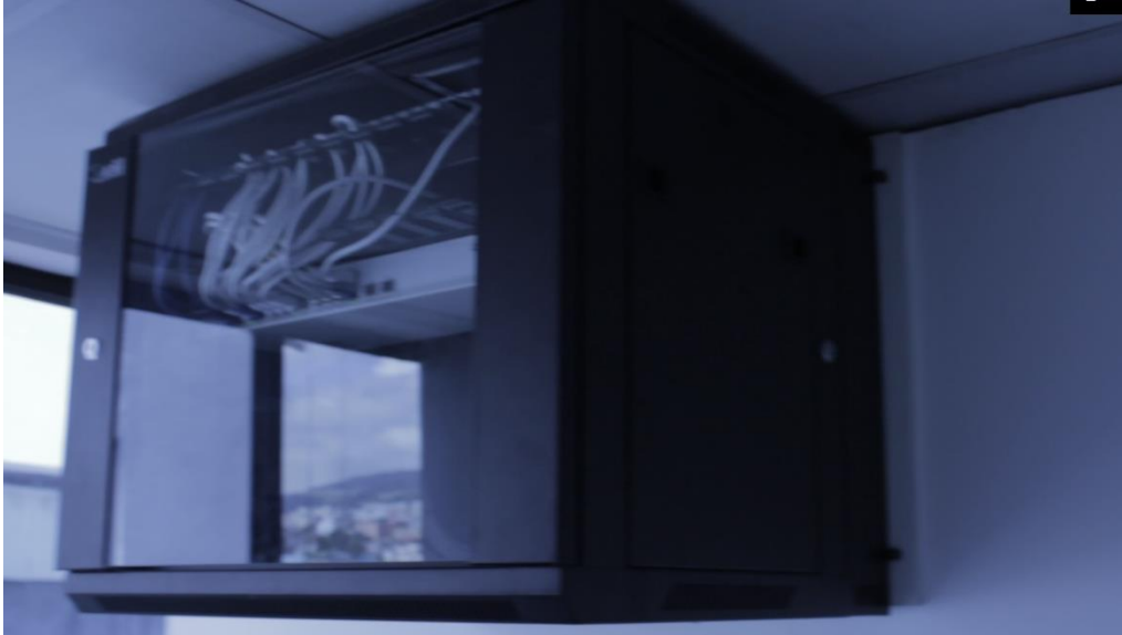
Figura. 4.15. Armario de comunicaciones
