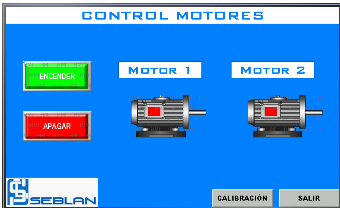
Figura 4.19 Pantalla control motores
