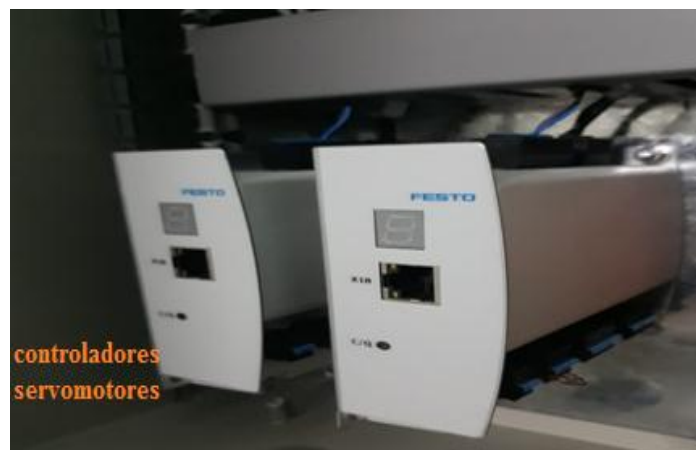
Figura. 4.13. Implementación de controladores de servomotores Festo
