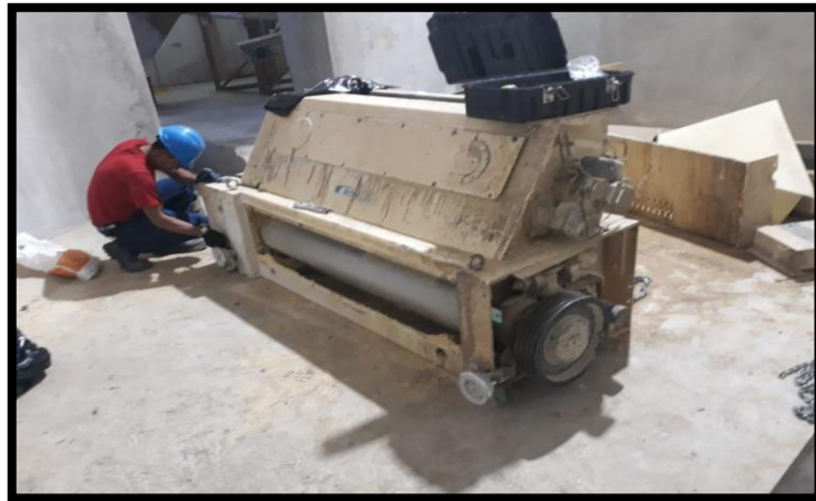
Figura. 4.2. Implementación del equipo en piso y mantenimiento
