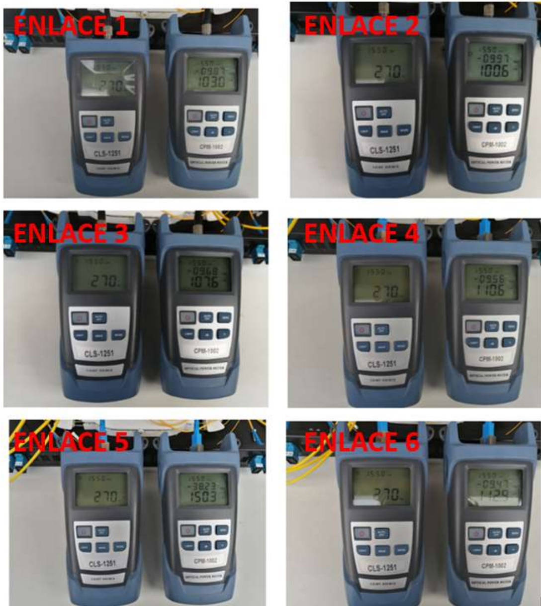
Figura 4.38 Pruebas de medidas de potencia en enlaces
