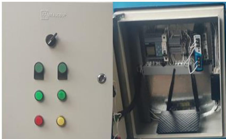
Figura. 4.44. Caja de control interna.
