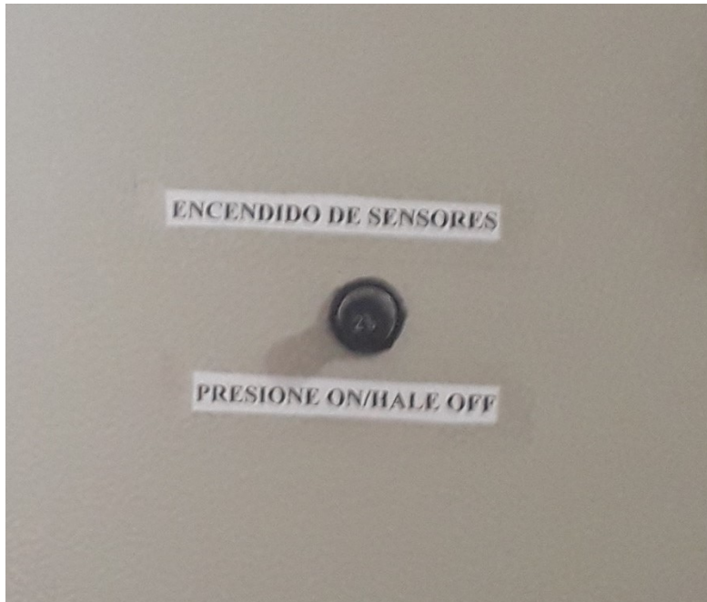
Fig. 8-4 Switch para encendido de sensores
