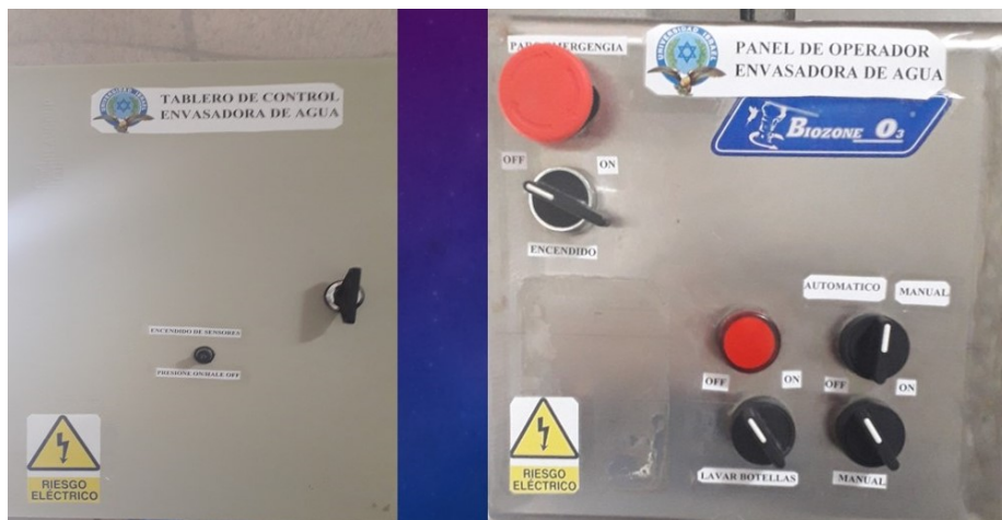
Figura. 4.20 Tablero de control y panel de operador con identificación y señalización
