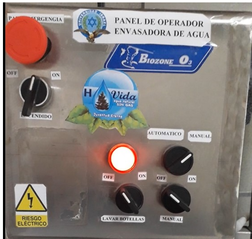
Fig. 8-3 Panel de operador funcionando
