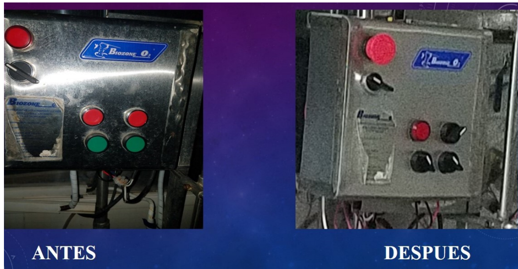
Figura. 4.18 Readecuación de panel de operador
