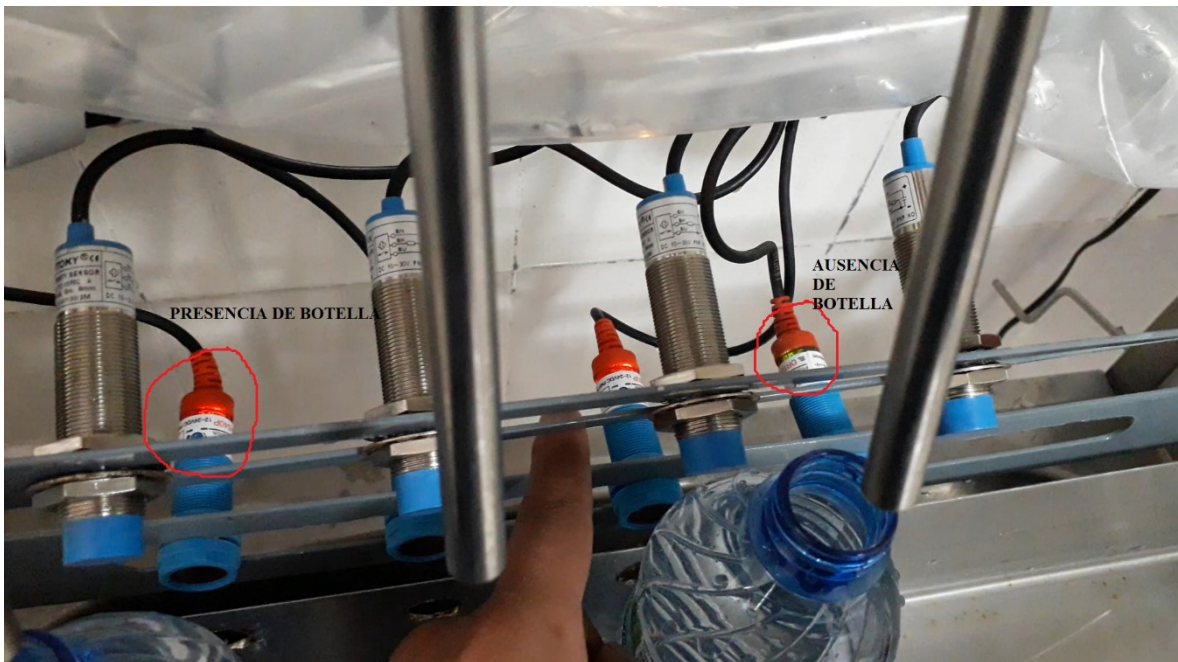
Figura. 4.22 Pruebas de funcionamiento, sensores fotoeléctricos.
