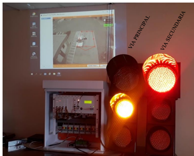
Figura 4.31. Detección de vehículo, inicio de cambio de fase. Fuente: Elaborado por el autor.
