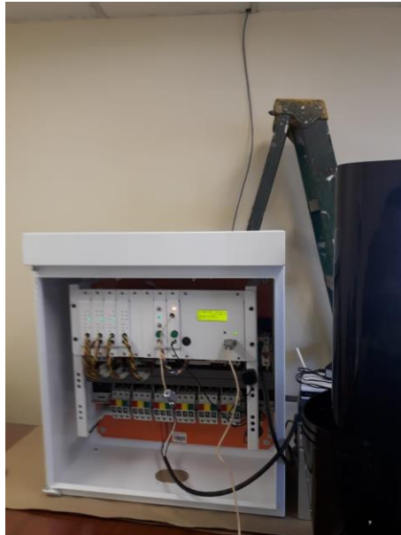
Figura 4.25. Ubicación y conexión del controlador de tráfico. Fuente: Elaborado por el autor.
