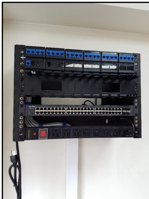
Figura 4.56 Equipos instalados en Rack Elaborado por: El Autor
