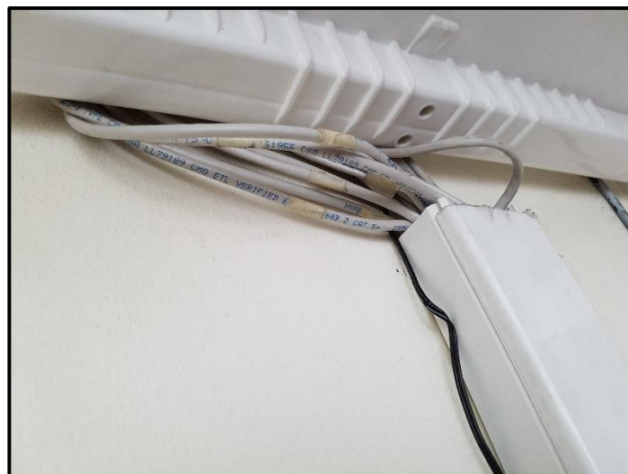
Cableado y canaletas en mal estado
