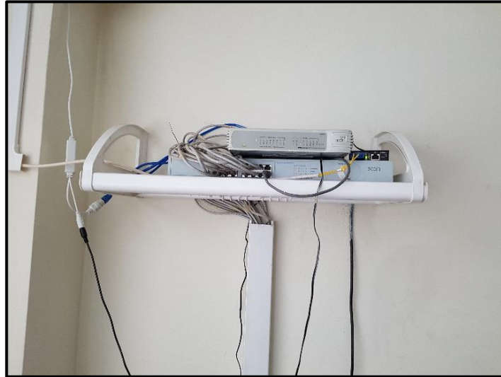
Switch 3COM en malas condiciones
