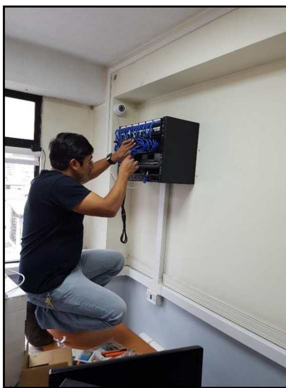
Figura 4.17 Conexiones entre el Switch y el Patch panel Elaborado por: El Autor
