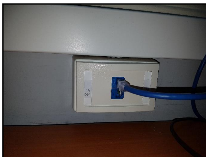
Figura 4.71 Conexión de terminales a la red LAN Elaborado por: El Autor
