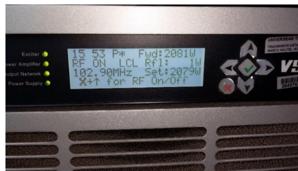
Figura 4. 23 Transmisor operando a 2081W de potencia directa.
