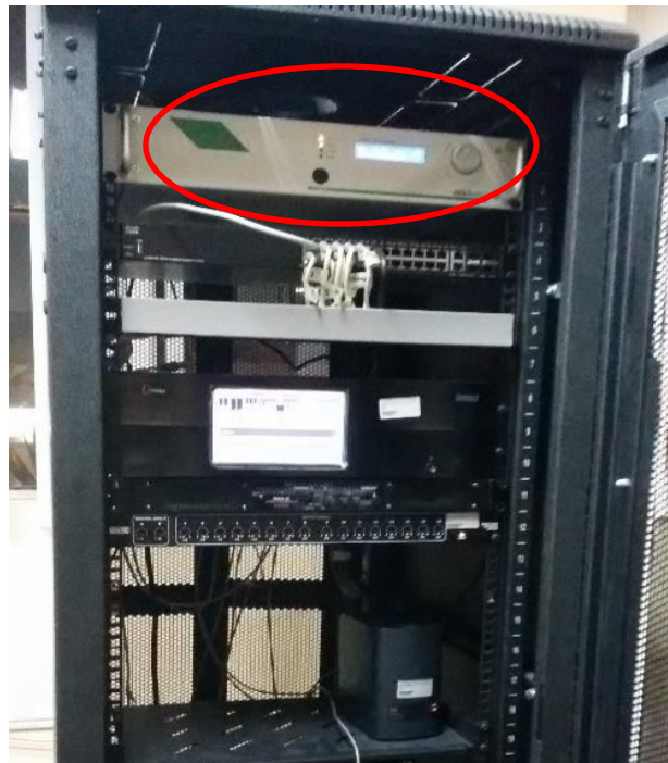
Figura 4. 5 Transmisor de enlace instalado en el rack.
