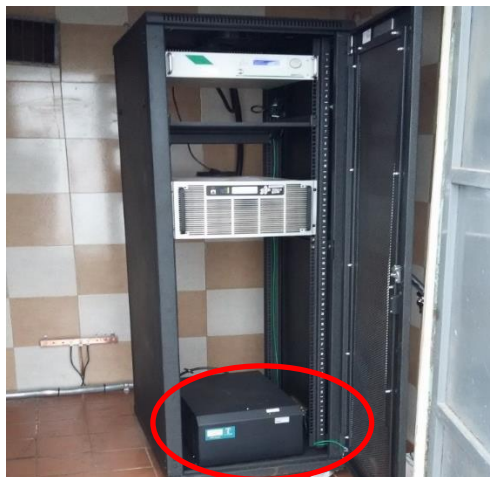
Figura 4. 14 Regulador de voltaje 10KVA
