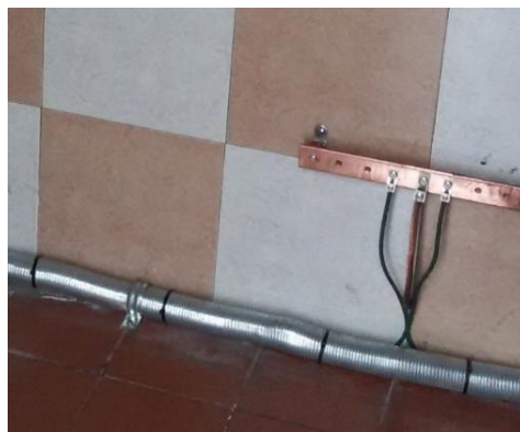
Figura 4. 17 Barra colectora del ring de tierra
