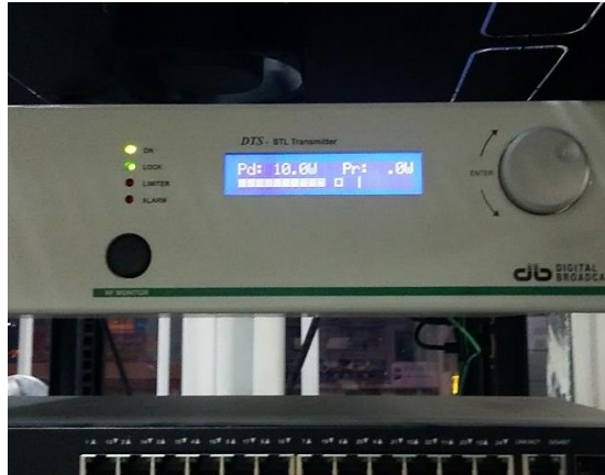
Figura 4. 8 Transmisor de enlace operando con 10 W
