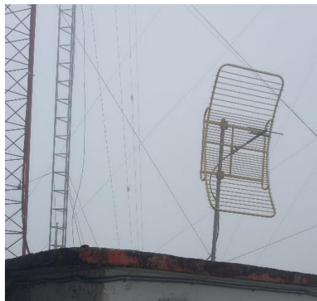
Figura 4. 11 Antena paraflector de recepción instalada en la torre.
