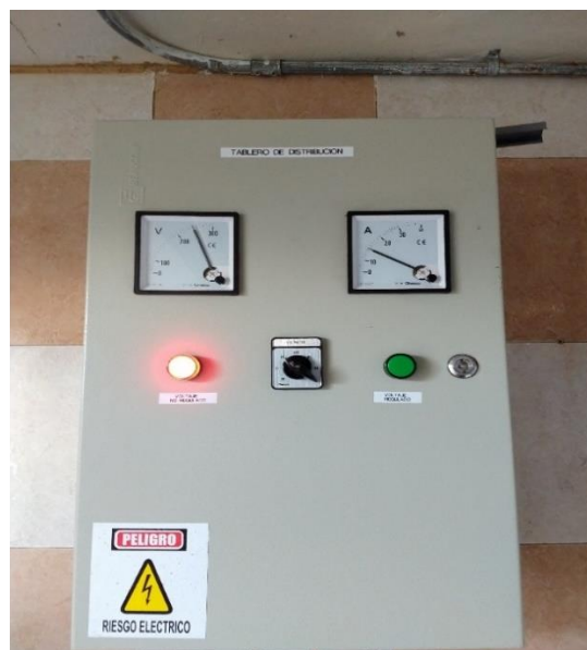
Figura 4. 13 Tablero de distribución de energía
