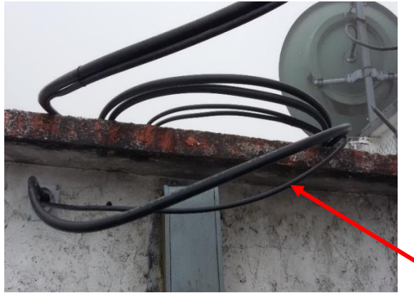
Figura 4. 10 Ingreso de cables a la caseta
