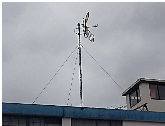
Figura 4. 7 Antena paraflector de transmisión instalada en trípode
