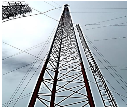
Figura 3. 28 Torre soportada por tensores.
