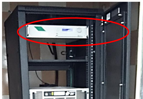
Figura 4. 9 Receptor de enlace instalado en rack de equipos.
