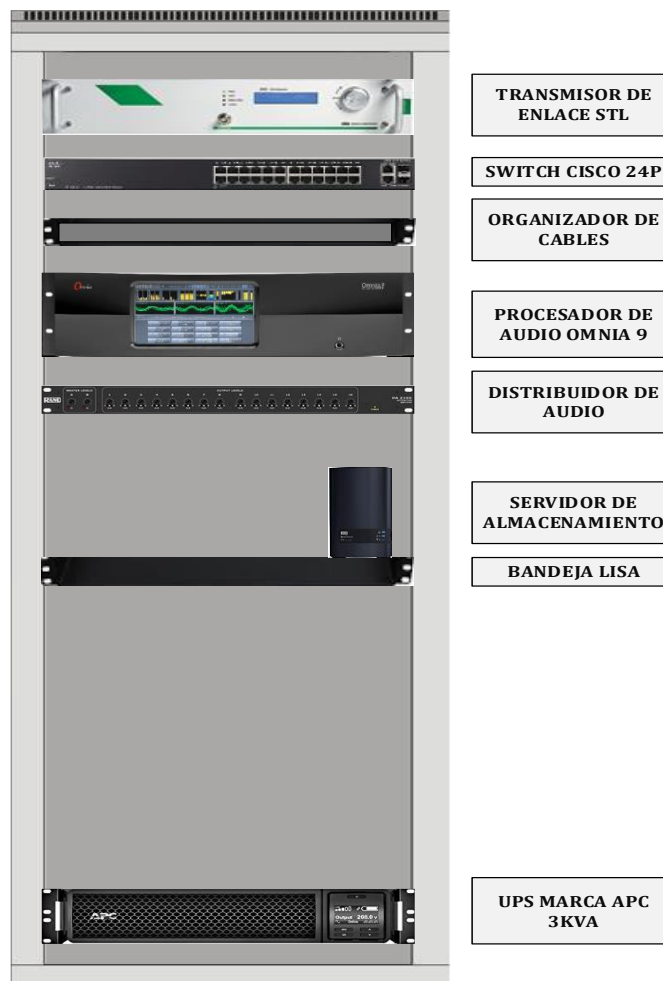
Figura 4. 3 Distribución de rack de equipos en Estudios.
