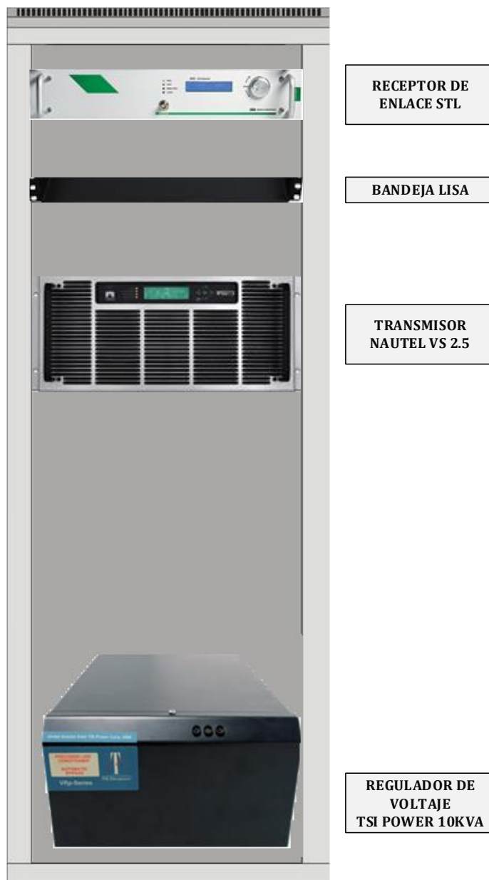
Figura 4. 4 Distribución de rack de equipos en cerro Pilisurco.
