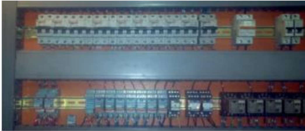
Figura 6: Tablero de control electro-mecánico
