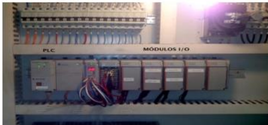
Figura 7: Tablero de control por PLC
