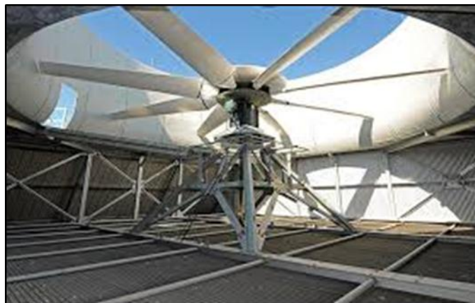
Figura 1. 6. Ventilador de la torre. Fuente: GRUNDFOS (2018)
