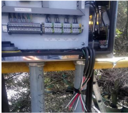
Figura 4. 51. Cableado a gabinetes. Fuente. Elaborado por el autor.
