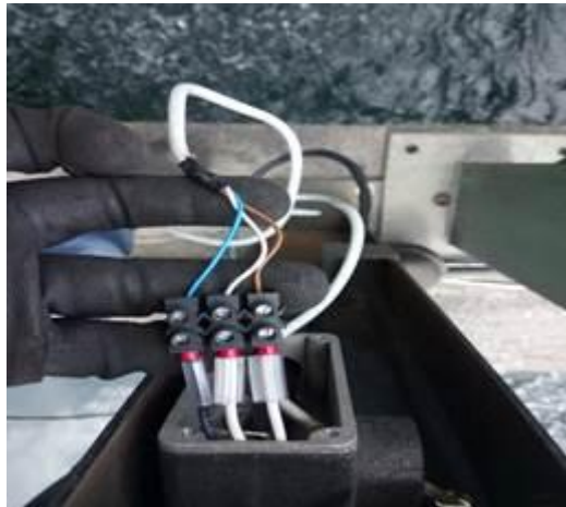
Figura 4. 17. Conexionado. Fuente. Elaborado por el autor.
