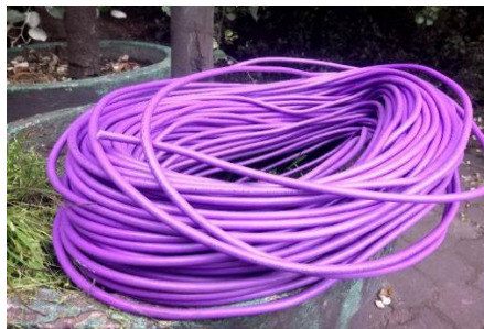
Figura 4. 53. Cable profi-bus Fuente. Elaborado por el autor.
