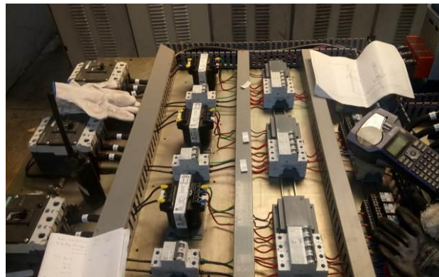
Figura 4.31. Cableado Fuente. Elaborado por el autor.
