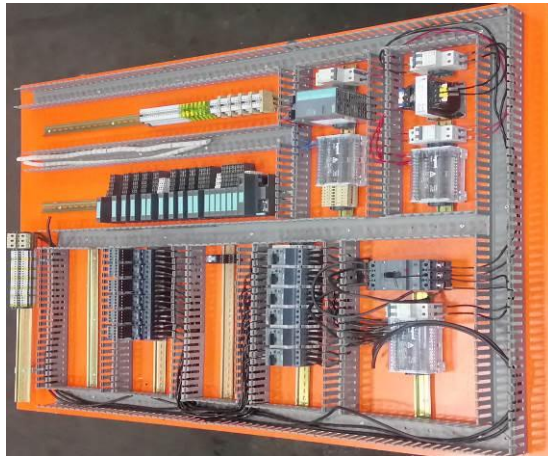
Figura 4. 22. Cableado. Fuente. Elaborado por el autor.
