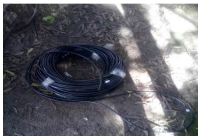
Figura 4. 50. Cableado conductores. Fuente. Elaborado por el autor.
