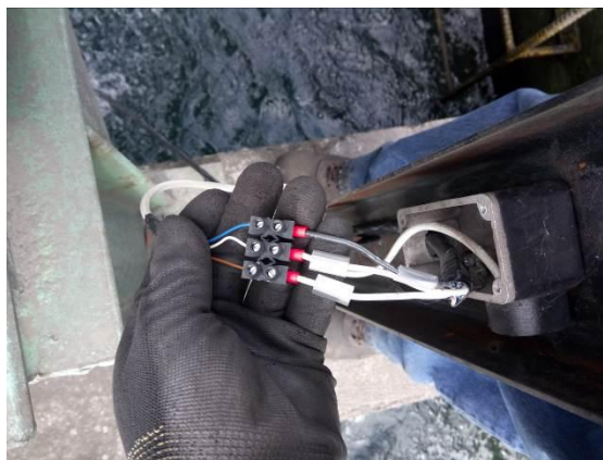
Figura 4. 13. Cableado. Fuente. Elaborado por el autor.
