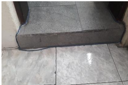
Figura 3.4 Cableado por el piso
