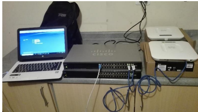
Figura 4.46 Configuración de equipos.
