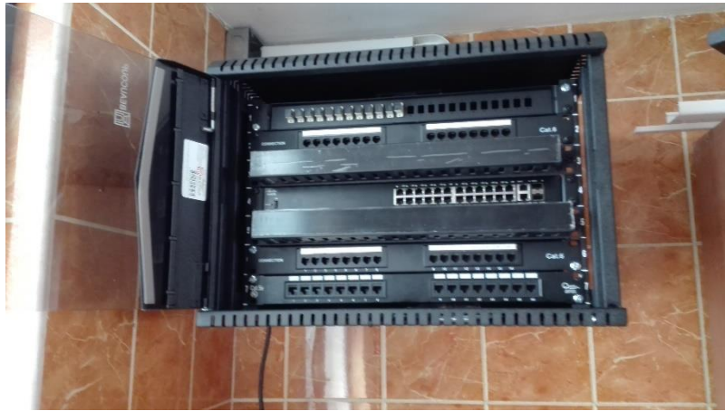
Figura 4.19 Elementos del rack instalados
