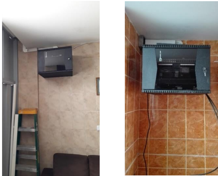
Figura 4.18 Racks instalados piso 2 y 3
