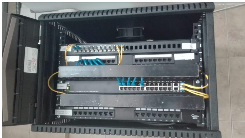
Figura 4.41 Conexiones dentro del rack .
