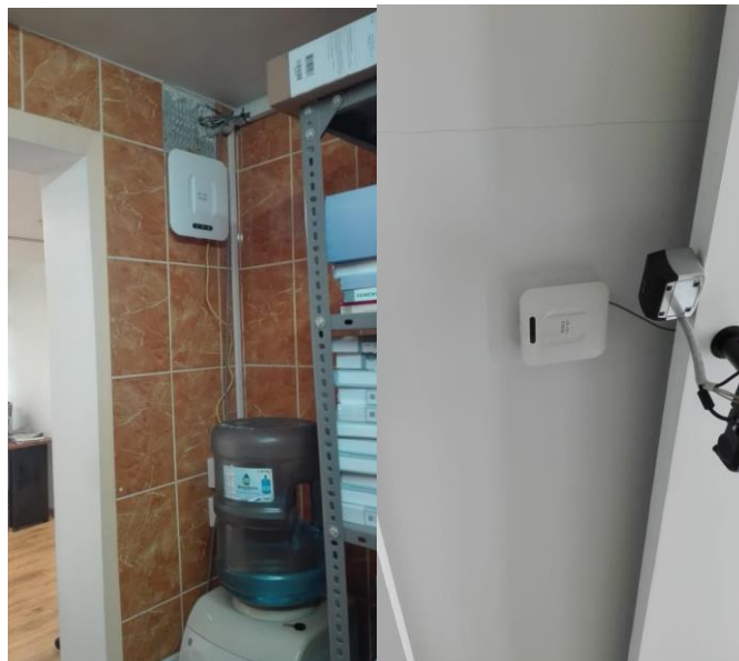
Figura 4.45 Instalación de equipos Wi-Fi .
