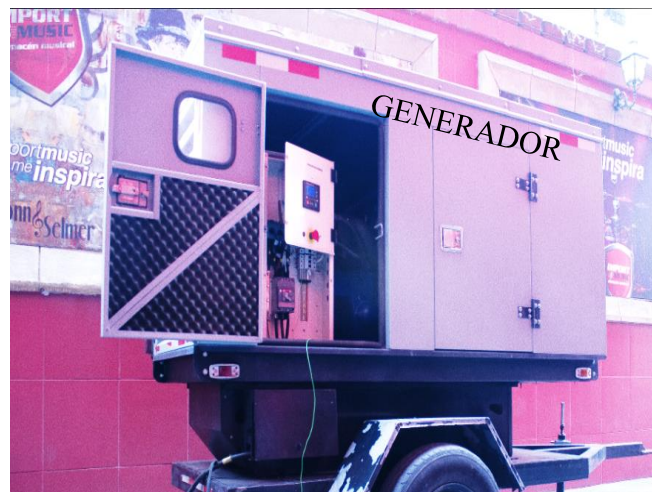
Figura 56. Funcionamiento de generador (Fuente: Elaboración propia)
