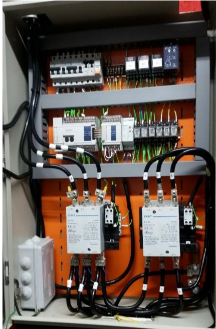
Figura 41. Conexión con el tablero de distribución (Fuente: Elaboración propia)
