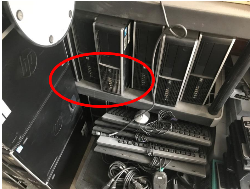
Figura. A.2. Fotografía donde se evidencia polvo y basura en los equipos Fuente: Investigación propia
