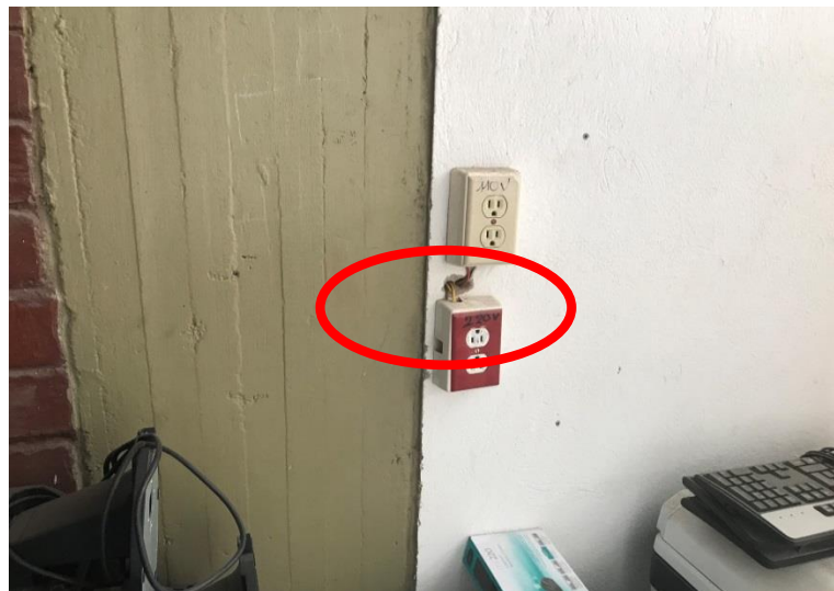
Figura. A.3. Fotografía donde se evidencia que los cables eléctricos están sin protección Fuente: Investigación propia
