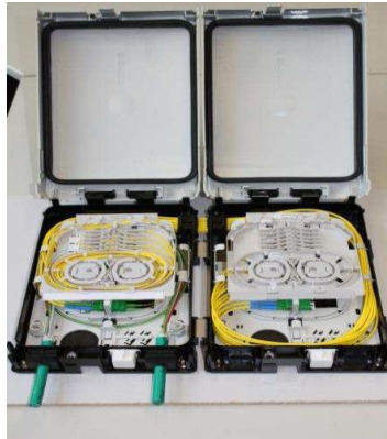
Figura 1.16 Caja de distribución secundaria FDF
