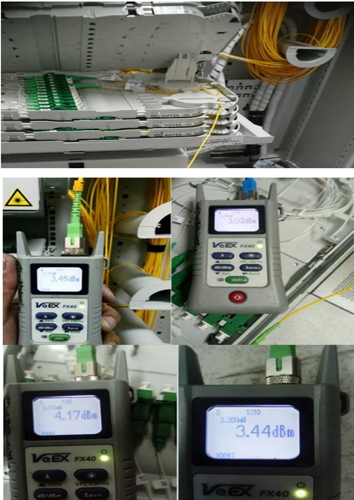
Figura 3.7 Pruebas de potencia en ODF
