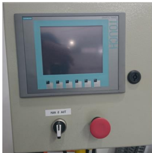
Figura 4.5. Colocación de pantalla HMI, selector y paro de emergencia.
