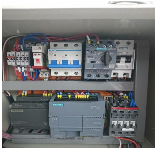
Figura 4.4. Cableado del tablero de control
