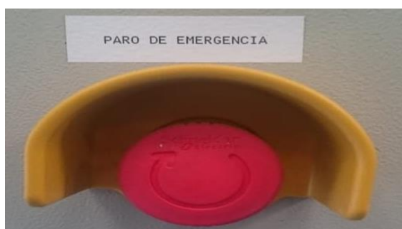
Fig. 3.31 Pulsador de emergencia
