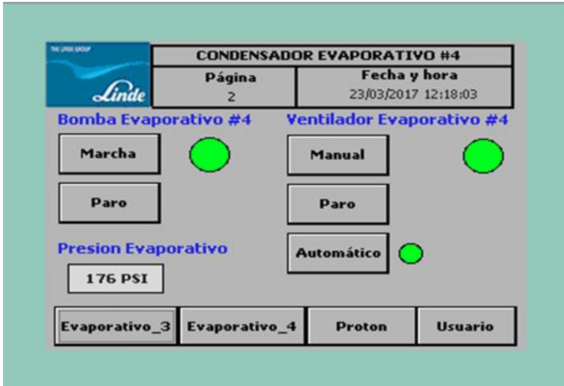
Figura 2.- Arranque/parada modo Automático Condensadores evaporativos.
