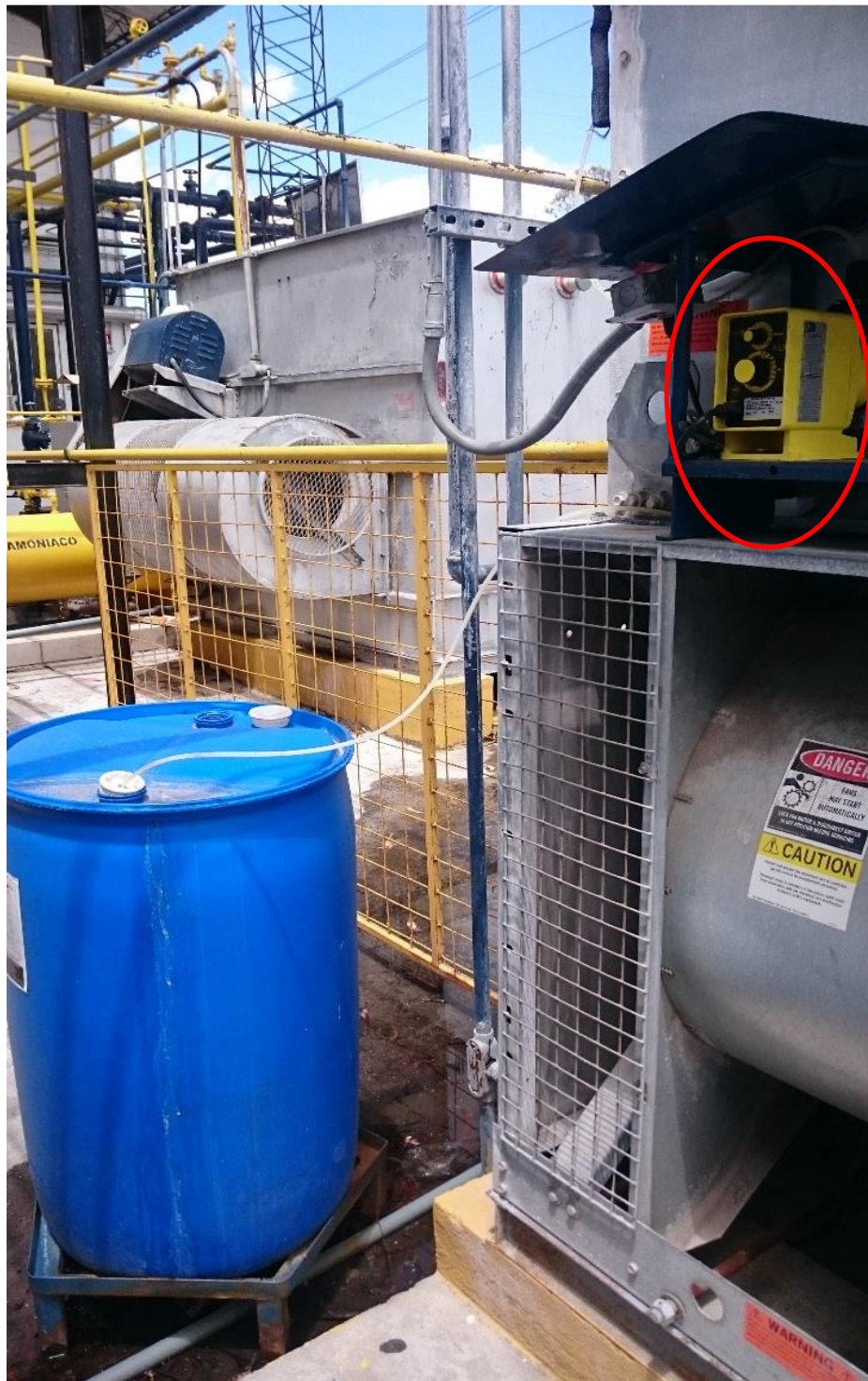
Fig. 4.5 Bomba dosificadora en condensador evaporativo
