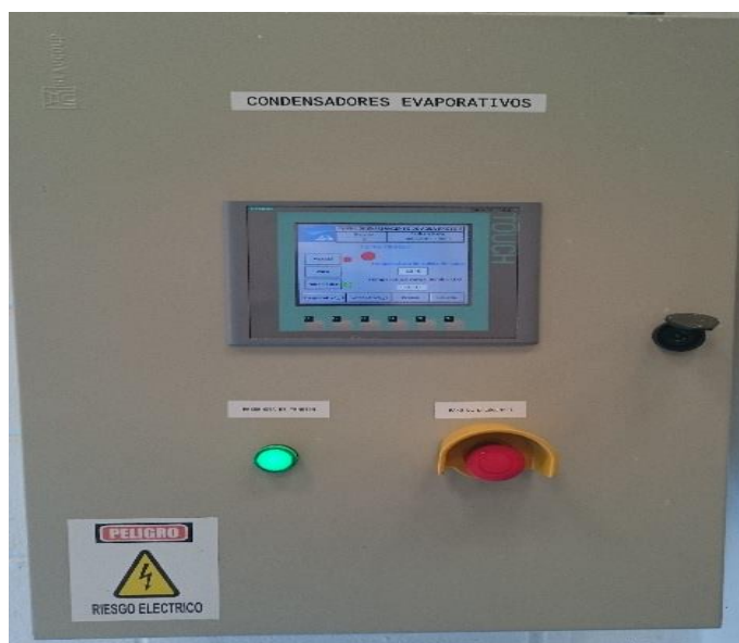
Fig. 4.8 Tablero eléctrico principal
