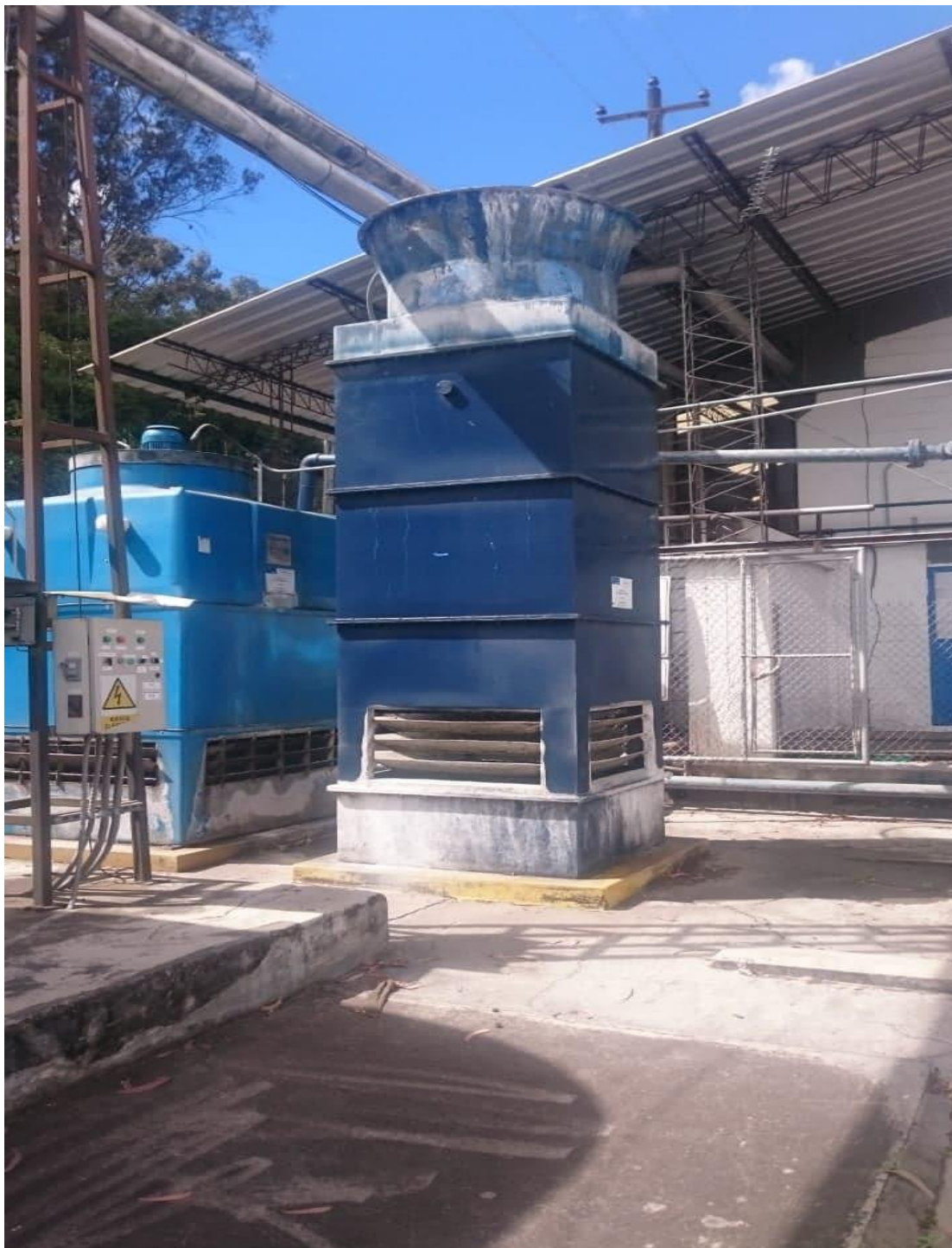
Torre de enfriamiento protón
