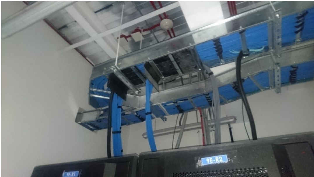
FIGURA 26. BANDEJA PORTACABLES PARA CABLEADO ESTRUCTURADO. Fuente: AUTOR.
