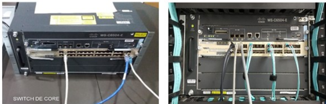
FIGURA 21. SWITCH DE CORE EN CONFIGURACIÓN E INSTALADO. Fuente: AUTOR.
