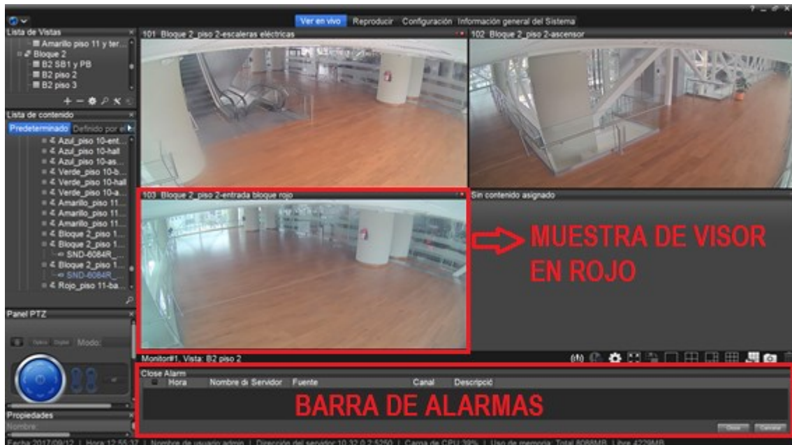
FIGURA 39. VISTA DE LA PANTALLA DE MONITOREO ANTE UNA ALARMA. Fuente: AUTOR.
