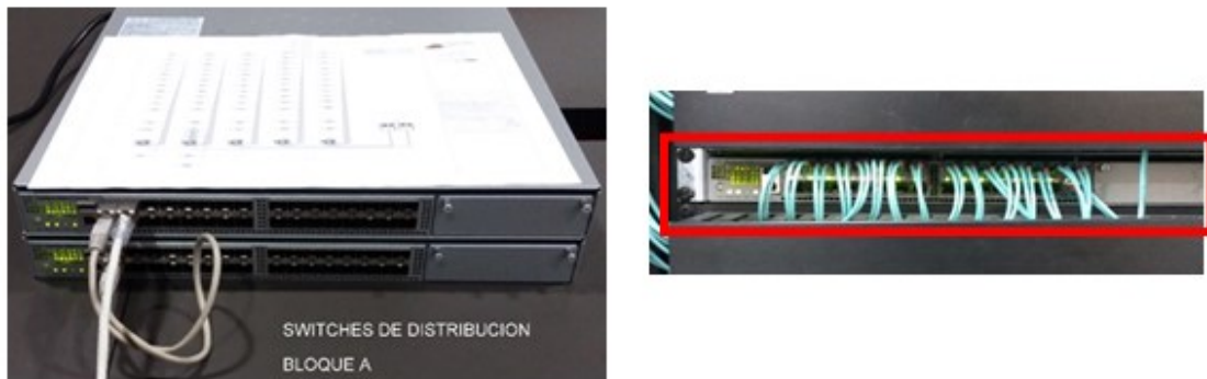
FIGURA 22. SWITCH DE DISTRIBUCIÓN EN CONFIGURACIÓN E INSTALADO. Fuente: AUTOR.
