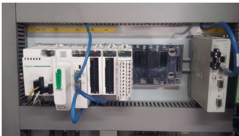
Figura 3.100. Equipos de la Familia M580 Instalados.
