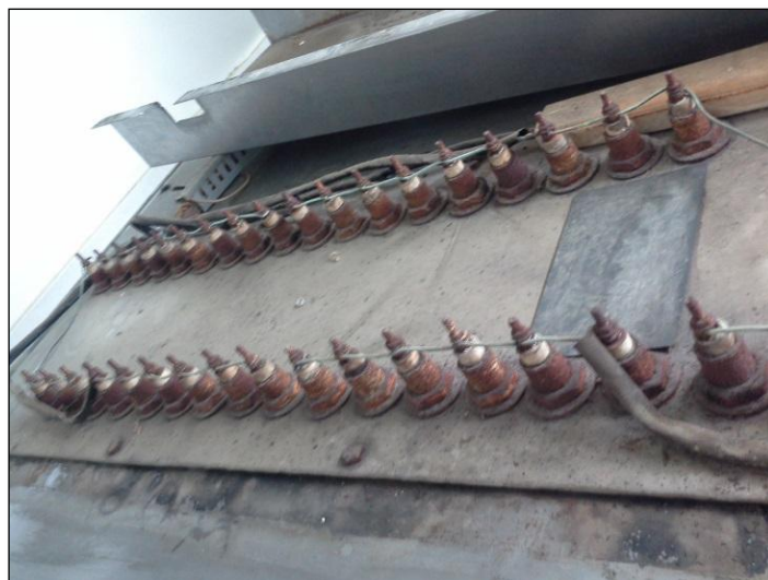
Gráfico 11.- Bloque de Conexiones de las Resistencias Tubulares
