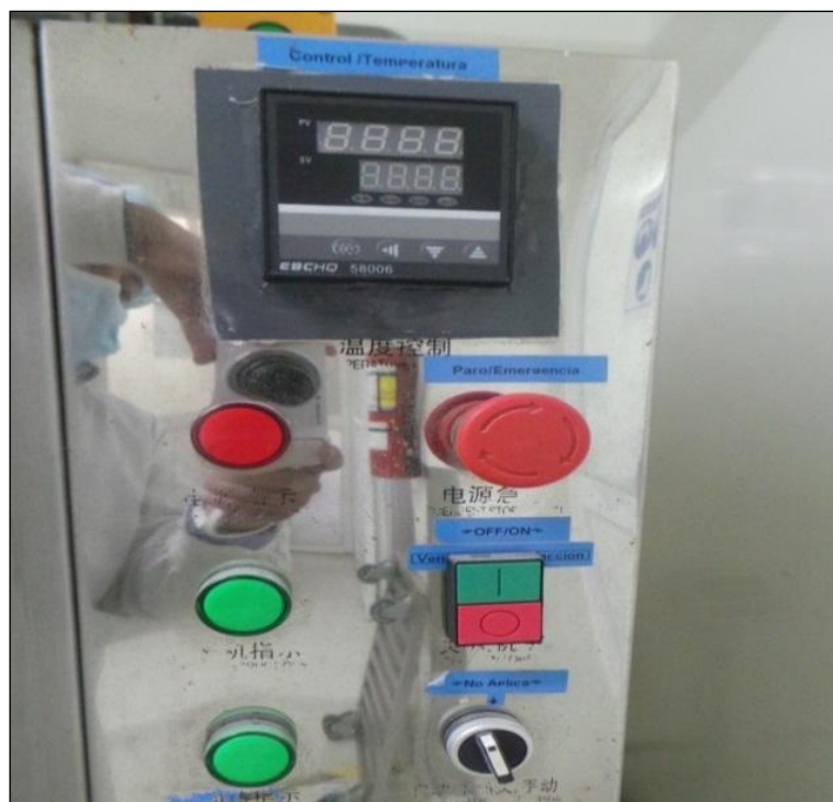
Gráfico 4.- Tablero Eléctrico del Horno.
