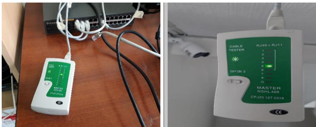
Figura 44. Equipo comprobador de red.
