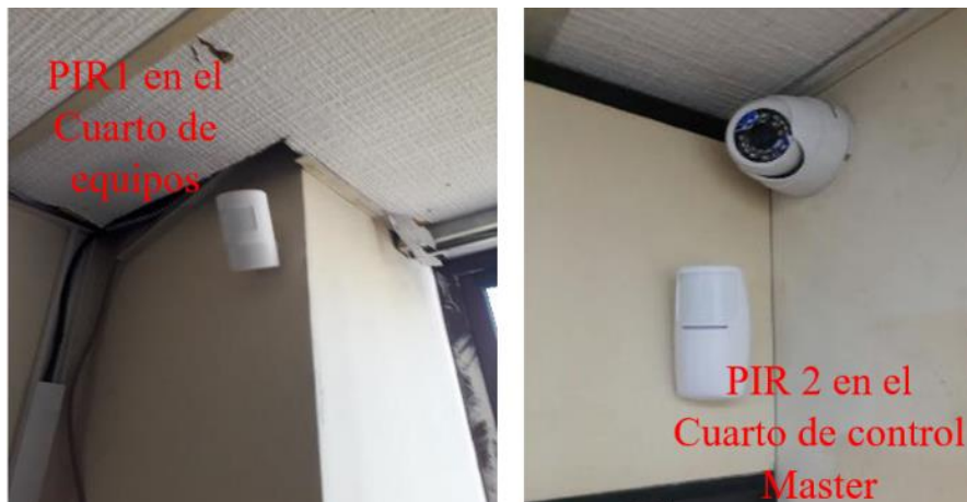
Figura 41. Sensores de movimiento PIR 1 y PIR2.
