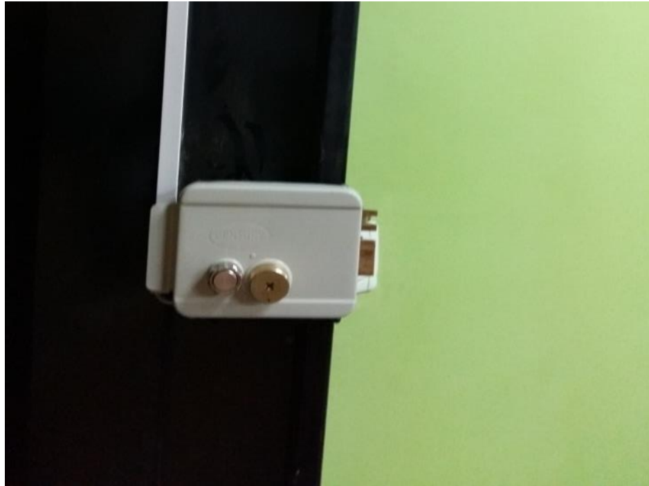
Figura 30. Instalación de la cerradura eléctrica en la puerta para su correcto funcionamiento.
