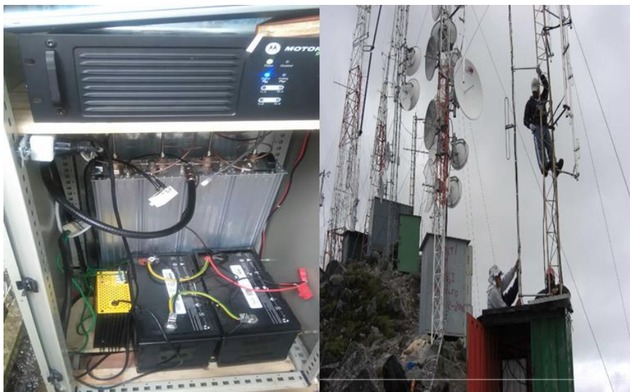
Figura 6. Sistema de Radiocomunicación, Repetidor, Duplexor y Antena
