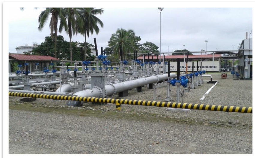
Imagen 18: Manifold de Válvulas entrada a la estación Lago Agrio
