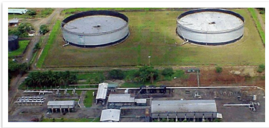
Imagen 1: Estación de Bombeo Lago Agrio
