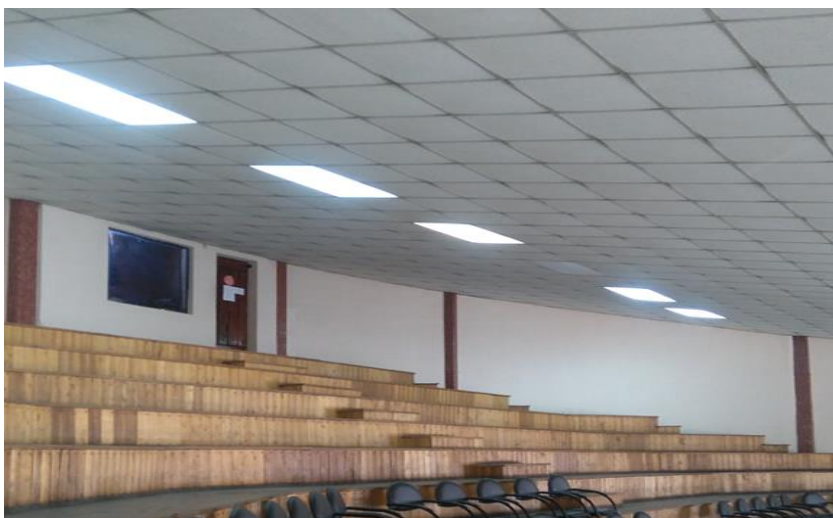
Figura 30: Encendido de luces fluorescentes del mezzanine
