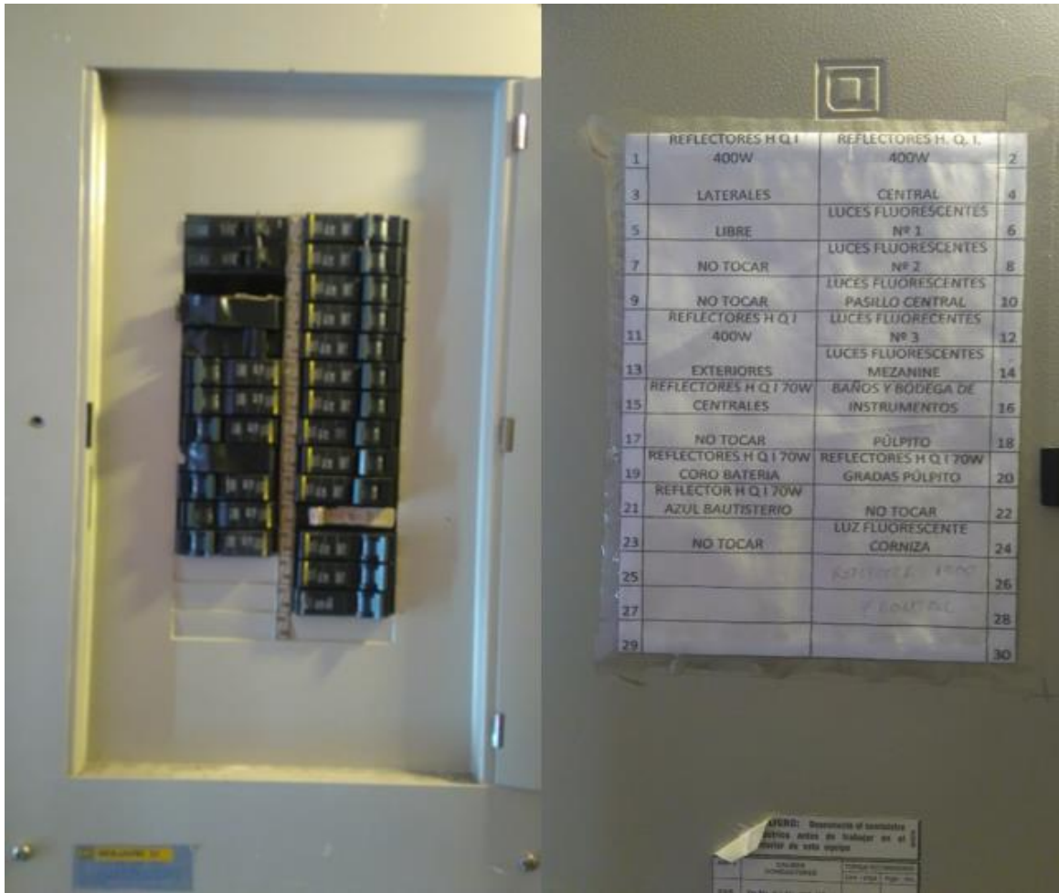
Figura 24: Caja de distribución de energía y nomenclatura de iluminación
