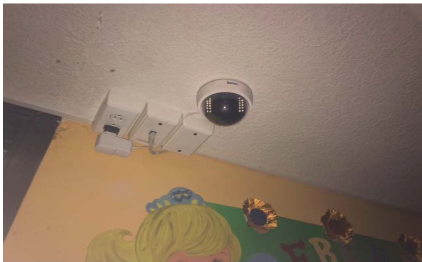
Imagen 29 : Ubicación Cámara IP 1 (Vista inferior)
