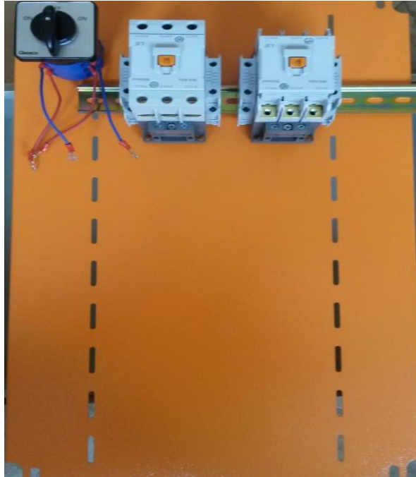
Gráfico 50.- Instalación de contactores
