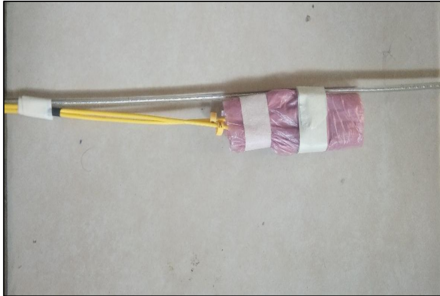
Figura 38: Protección de los conectores SC
