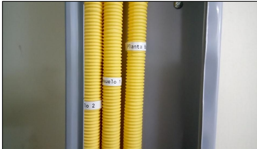
Figura 48: Identificación de mangueras en el cableado backbone
