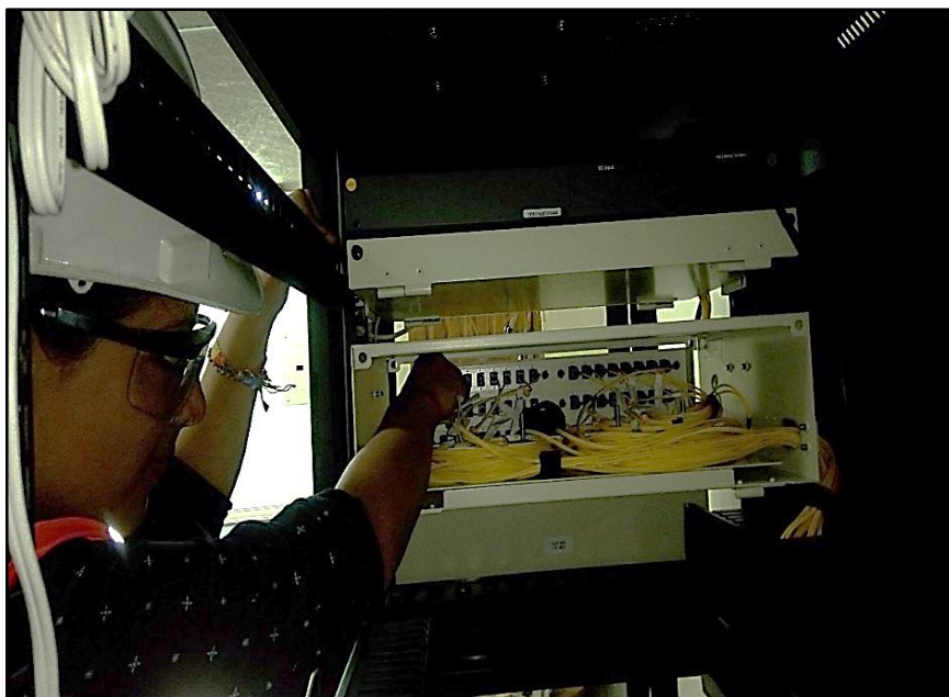
Figura 64: Etiquetado de patch cord desde la panel posterior del ODF
