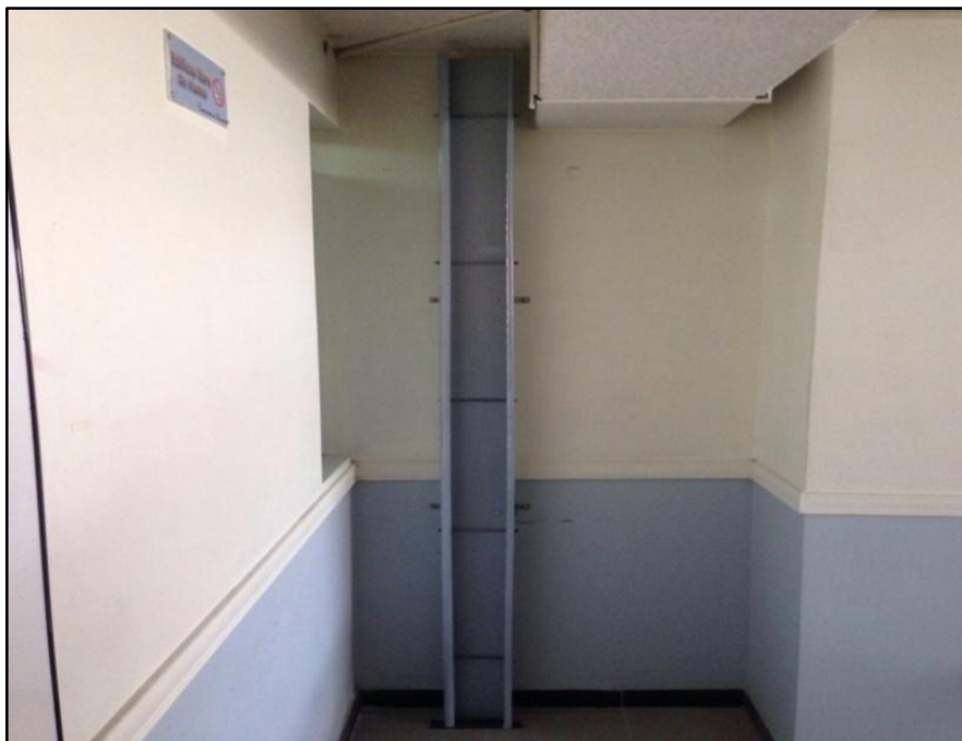
Figura 27: Canaleta cerrada o bandeja portacables instalada
