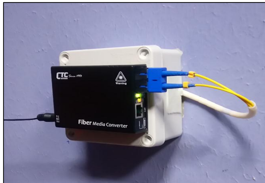
Figura 55: Transceiver con puerto para conector SC de la cancillería
