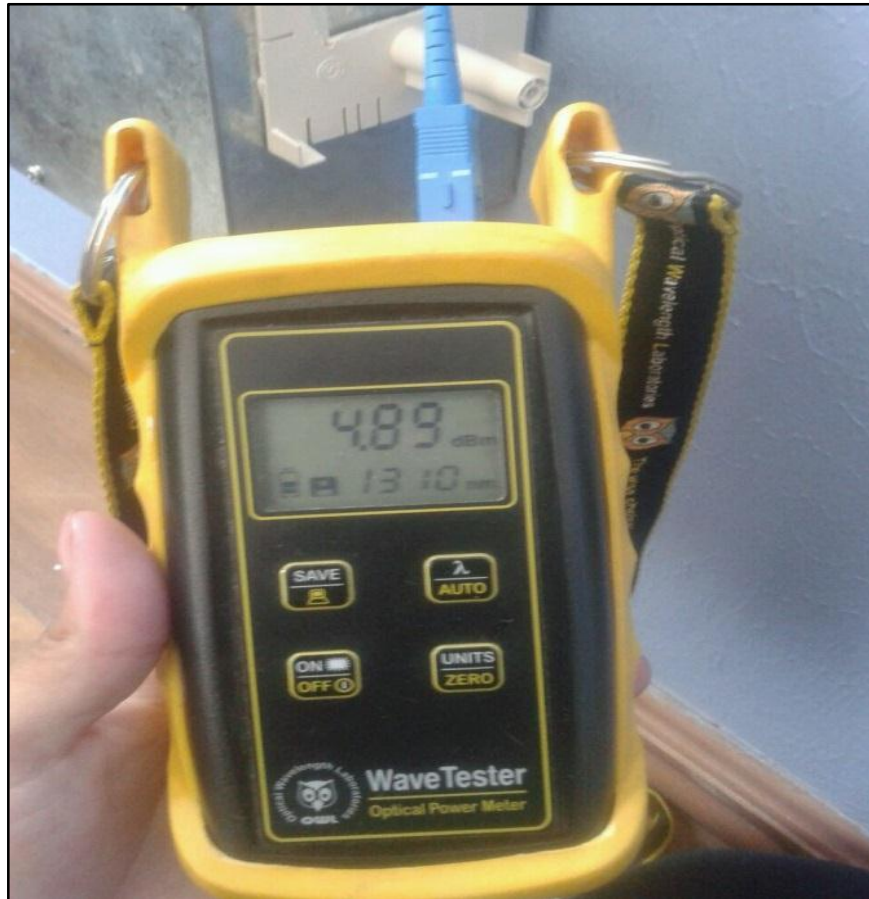
Figura 67: Medición del nivel de señal recibido en el patch cord A del aula 306
