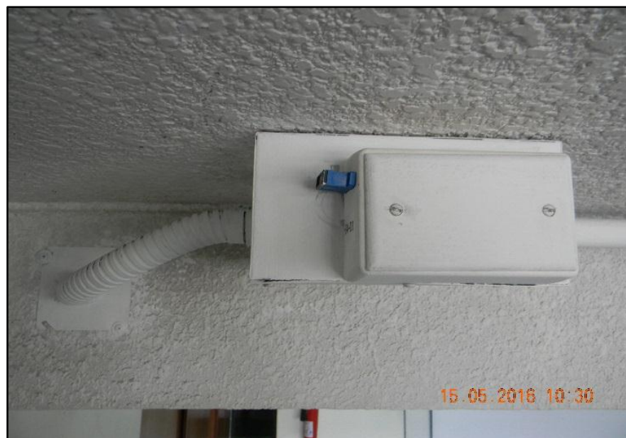
Figura 42: Punto de conexión a fibra óptica
