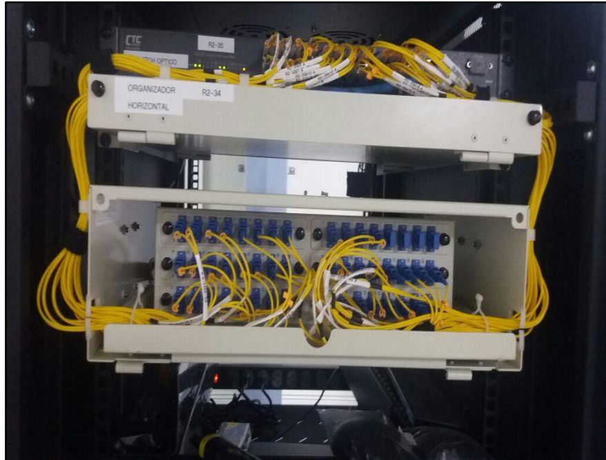
Figura 63: Etiquetado de patch cord del Switch al ODF
