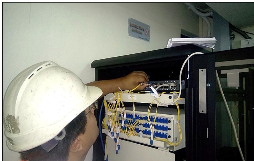
Figura 54: Colocación de módulos SFP en el Switch CTC del Rack 2 de la sala de telecomunicaciones
