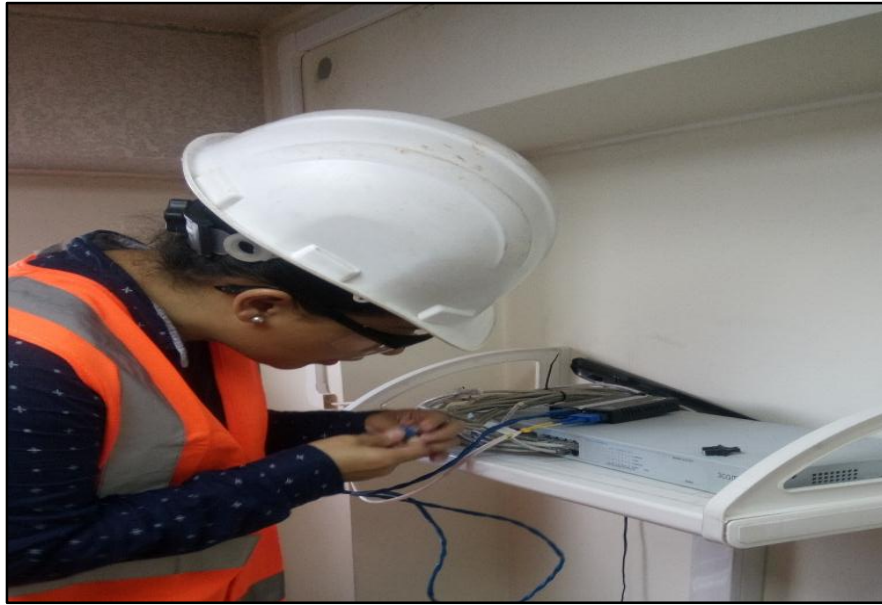
Figura 58: Conexión del transceiver al Switch eléctrico
