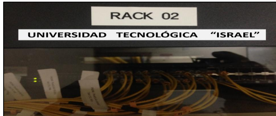
Figura 59: Etiquetado del rack que contiene los equipos de fibra óptica
