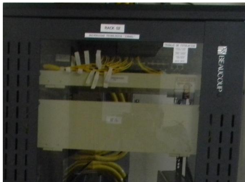
Figura 53: Etiqueta en el rack de equipos de fibra
