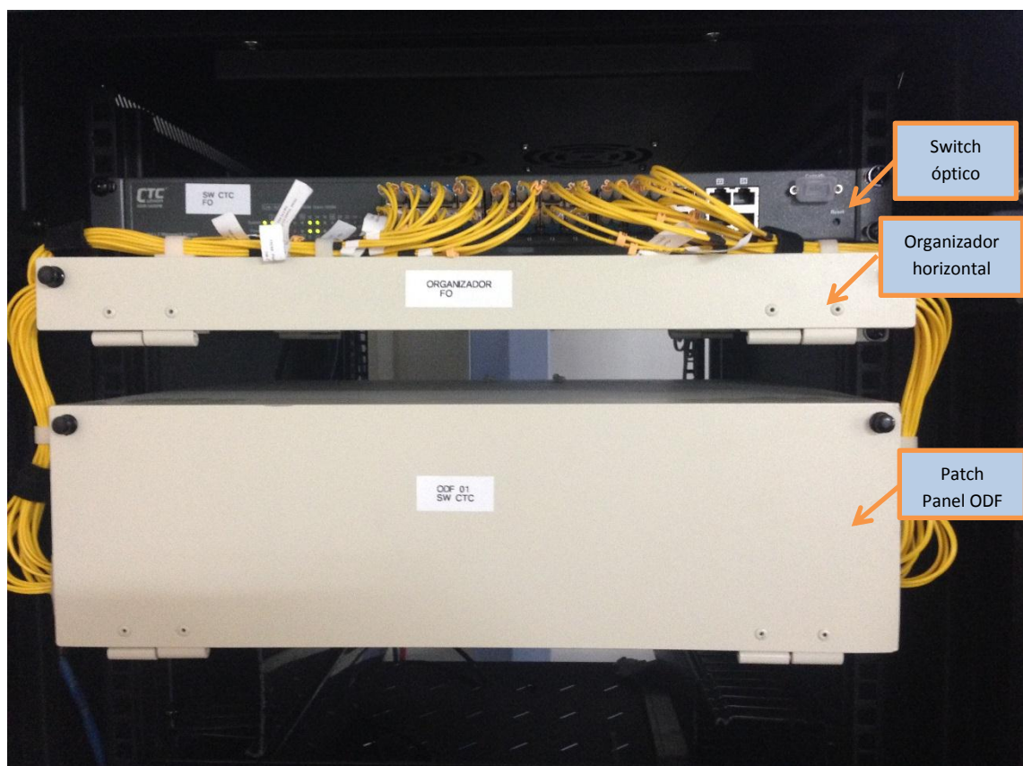
Figura 42: Equipos para distribución de fibra
