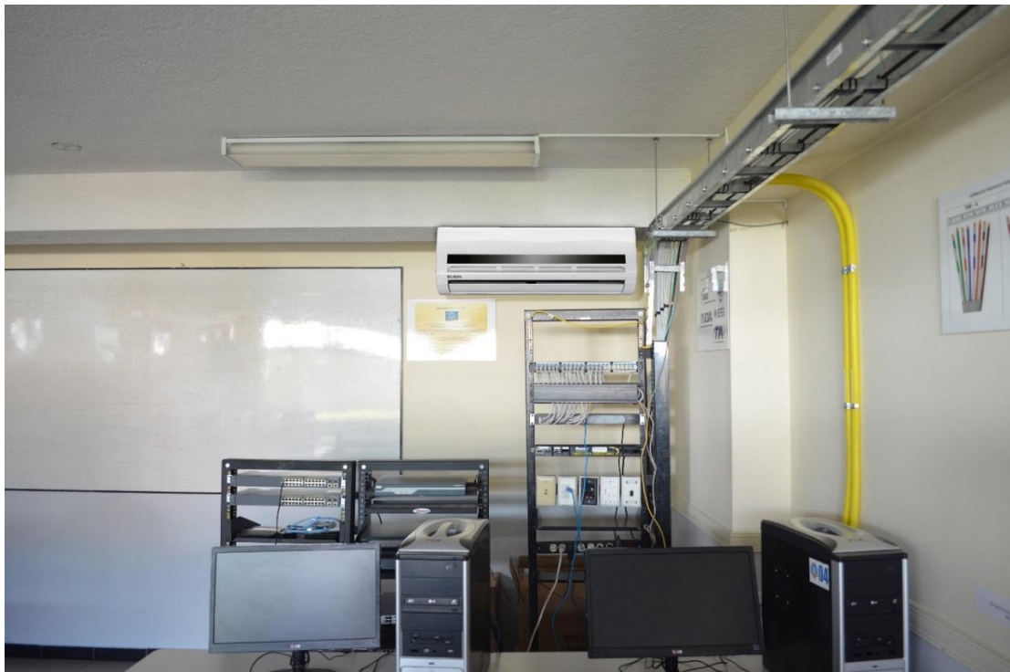
Figura 19. Fotomontaje Split Evaporadora, instalado en laboratorio de redes Fuente: Laboratorio de Redes, Universidad Israel
