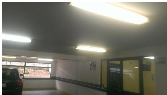
Figura 3.22 Sensor de base móvil instalado en el área 2
