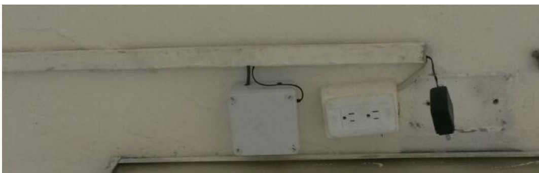
Figura 3.19 Dispositivo instalado y conectado al toma de alimentación
