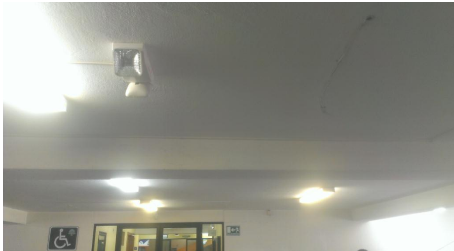
Figura 3.20 Red eléctrica guiada a través de canaletas
