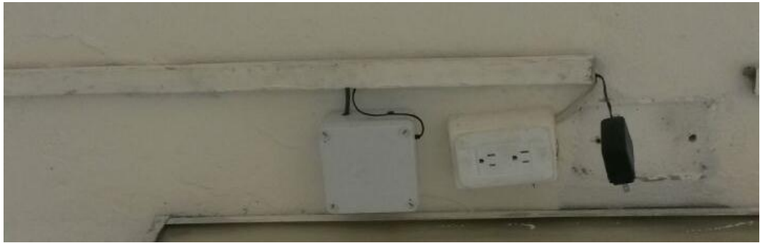
Figura 1.2 Dispositivo instalado y conectado al toma de alimentación
