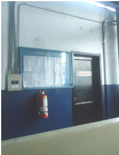
Imagen 4 Inexistencia de señalética en equipo contraincendios. Improvisación de señal consultorio médico, no cumple estandarización corporativa, señalética deteriorada, ubicación incorrecta de señalización.
