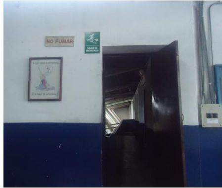
Imagen 2 Señalética no cumple con la norma iso-inen Señalética deteriorada, ubicación incorrecta. El Autor
