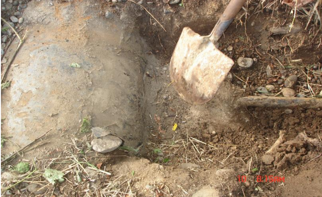
16.- Figura - Conexión Clandestina - Robo de Petróleo Línea de 26"
