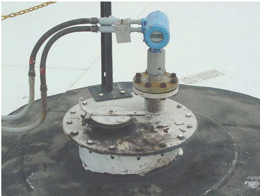
6.- Figura - Escotilla de Medición y Medidor de Nivel Tipo Radar
